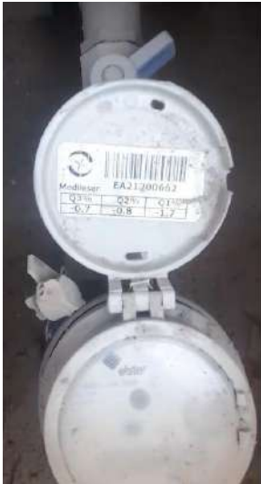
Medidor EA21200662 clandestino
