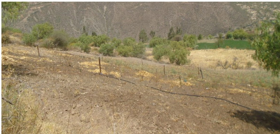
Figura 12: Sistema de riego en funcionamiento
