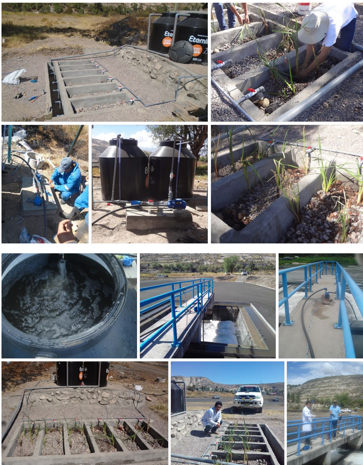
Fotografías N° 04. Superior indica instalaciones sanitarias del tanque cisterna y los humedales con tuberías PVC SAP Ø 2" y Ø 1/2", se muestran también las instalaciones de la electrobomba y las plantaciones de rizomas o plántulas de Typha angustifolia "totoras"; Inferior, indica el llenado de los tanques cisterna con aguas residuales provenientes del sedimentador integrado N° 2; además, el funcionamiento de los humedales una vez regulada y abierta las válvulas de ingreso que llevan aguas residuales a los humedales.
