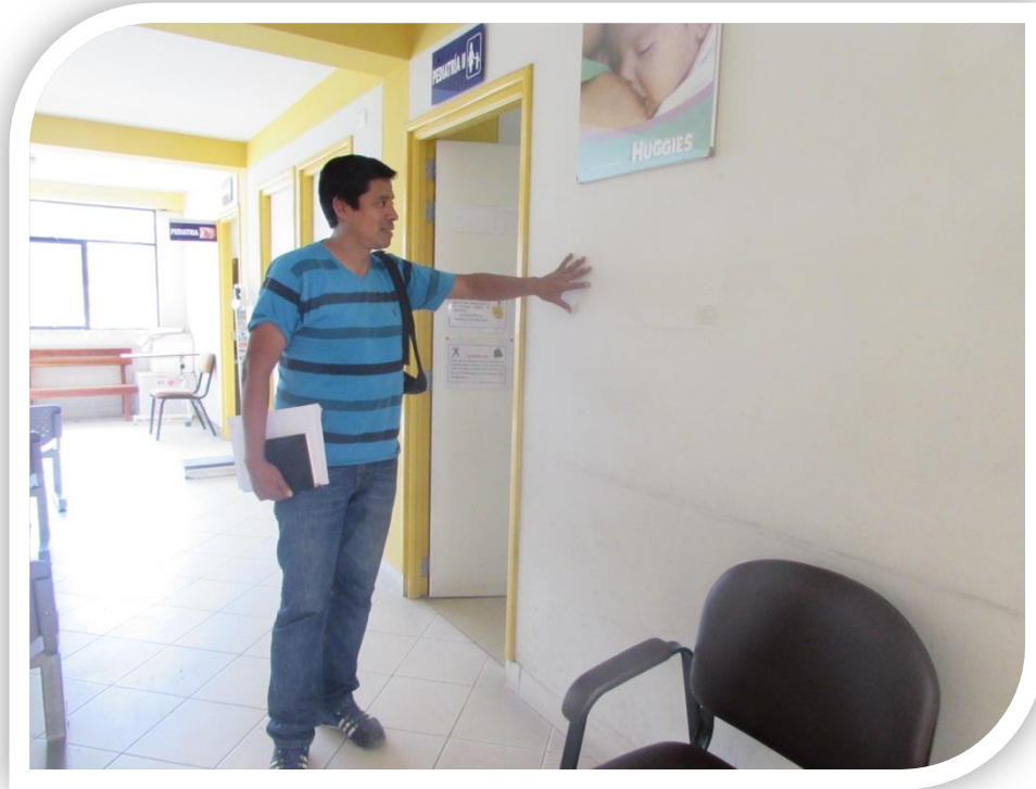
Fotografía 09. Vea la tipología aporticada con muros de fibrocemento en el interior del pabellón de Consultorios Externos del Hospital Regional de Ayacucho – 2do. Nivel.
