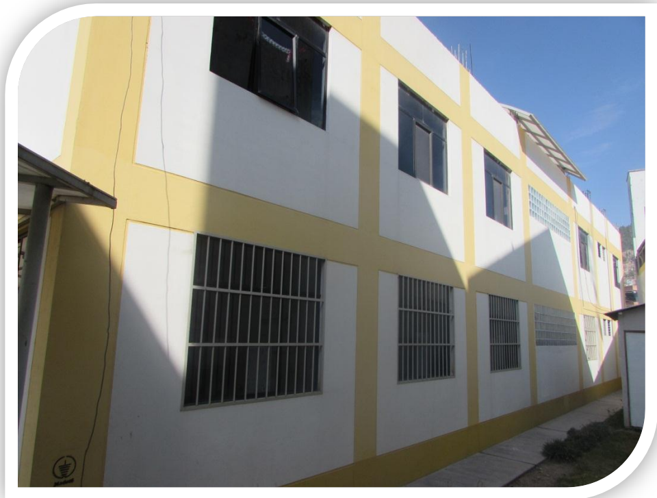
Fotografía 12. Vista posterior del pabellón de Consultorios Externos del Hospital Regional de Ayacucho. Observe el exterior con muros de albañilería confinada.
