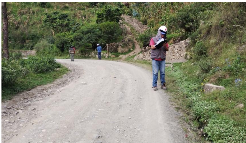
Figura 16. Ahuellamiento reclinado típico en curva
