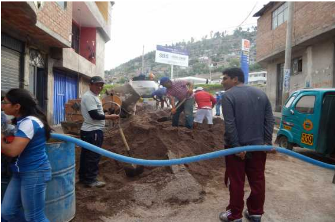
Foto 36: Dosificación de mezcla con palas, transporte con wincha y sin uso de compactación en vivienda N° 18
