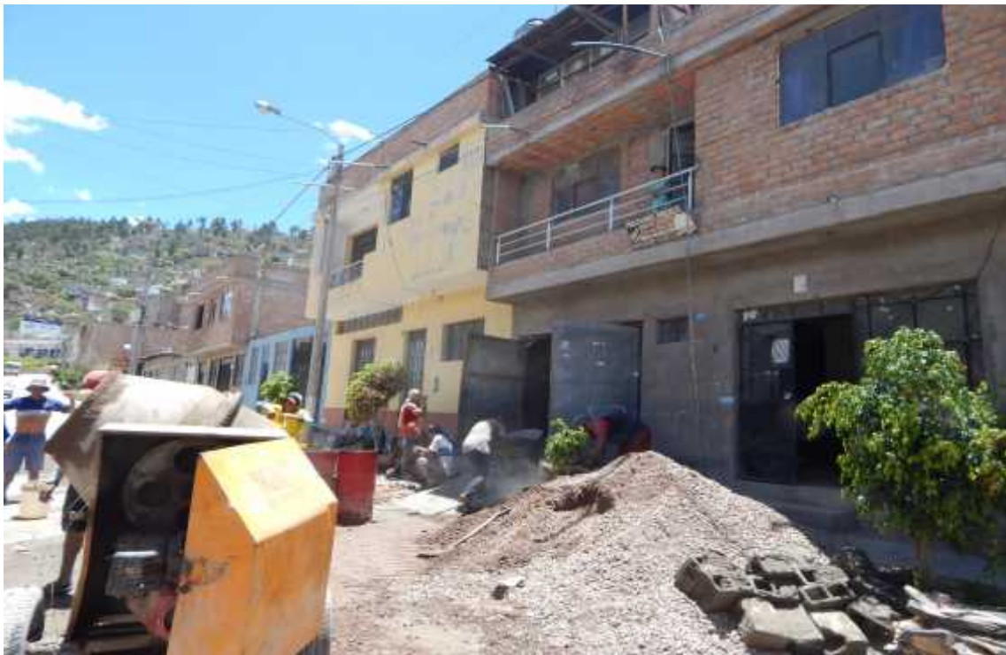
Foto 22: Dosificación de mezcla con pala, transporte en baldes y sin compactación en vivienda N° 11
