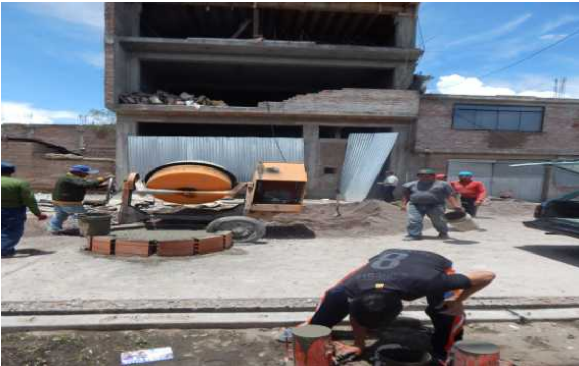
Foto 30; Dosificación de mezcla con palas, transporte en baldes y sin uso de compactación en vivienda N° 15
