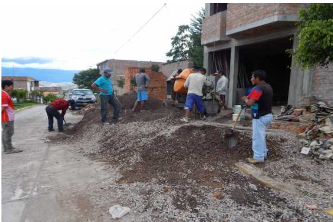
Foto 24: Dosificación de mezcla con pala, transporte con wincha y uso de compactación en vivienda N° 12
