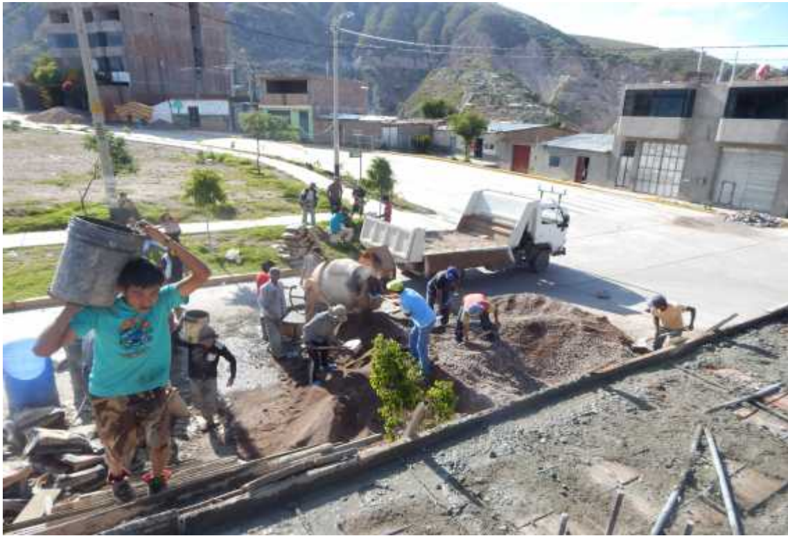
Foto 5; Transporte de concreto en baldes y dosificación de la mezcla con palas en forma artesanal y tradicional en vivienda N° 2
