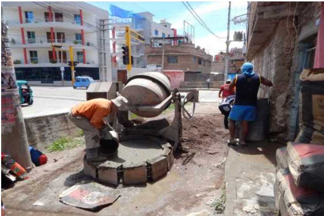
Foto 28: Dosificación de la mezcla con pala, transporte en baldes y sin compactación de la vivienda N° 14
