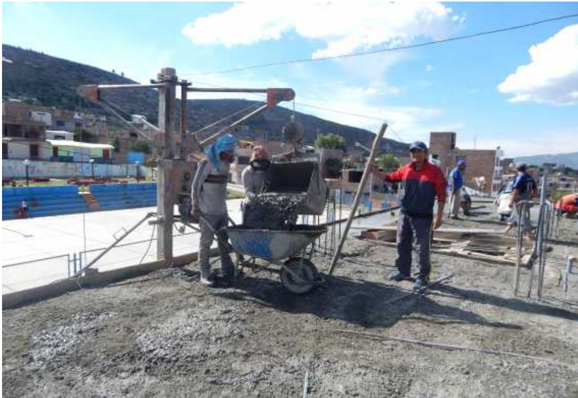
Foto 3: Transporte del concreto con uso de wincha y sin uso de compactación
