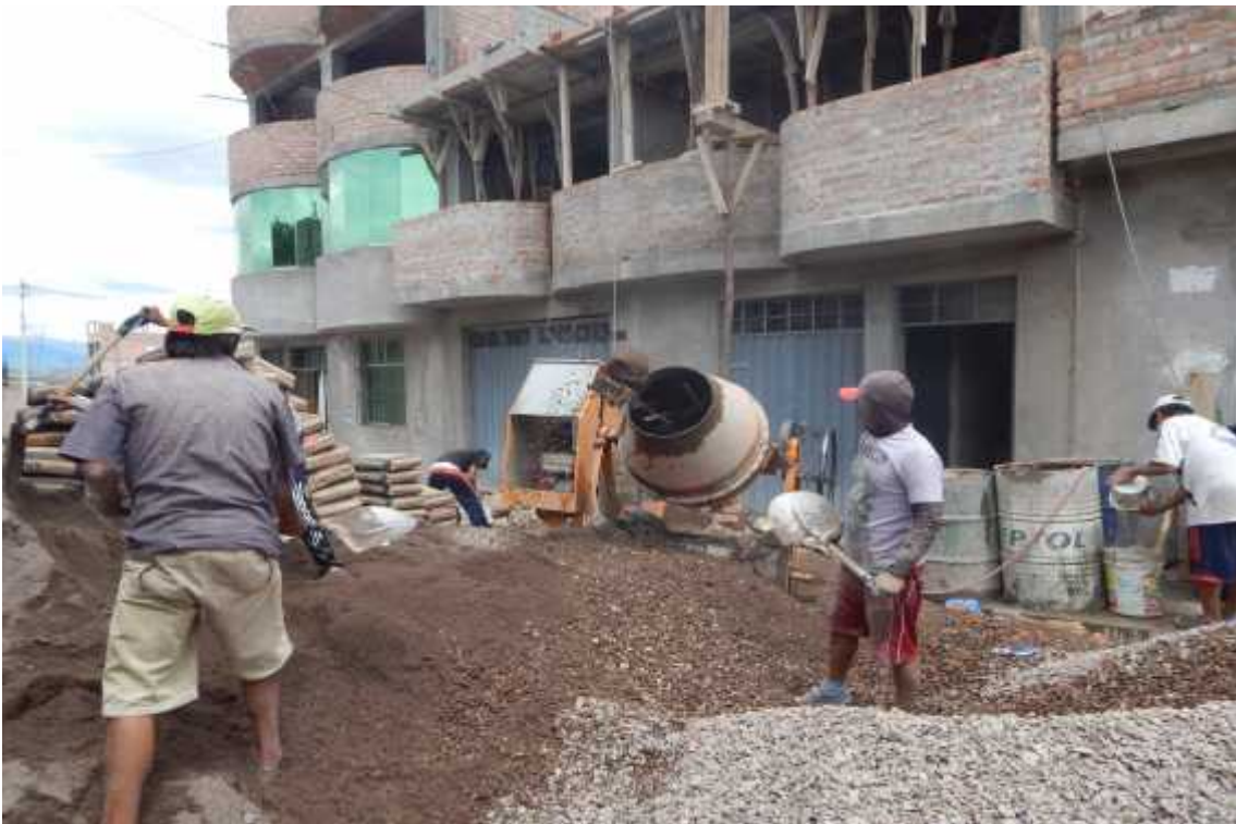
Foto 34: Dosificación de mezcla con palas, transporte con wincha y sin uso de compactación en vivienda N° 17
