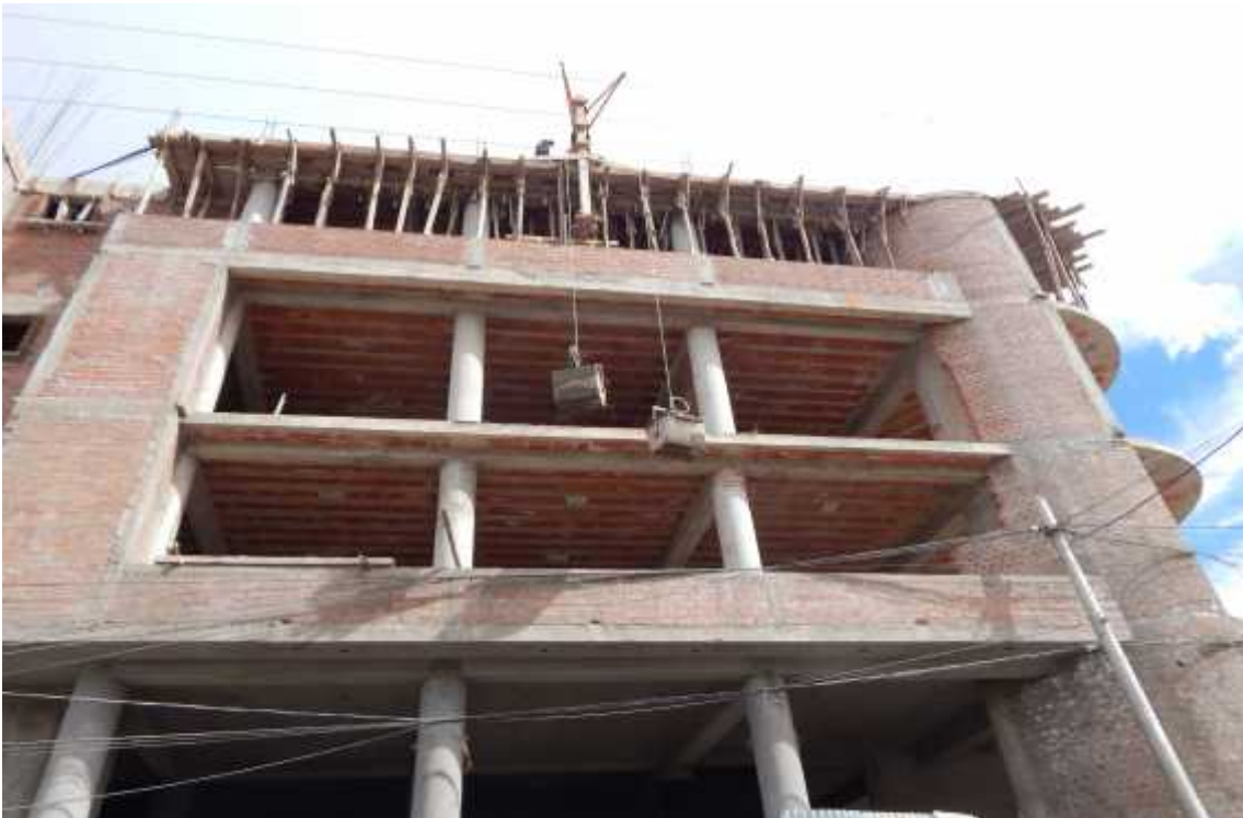
Foto 18: Utilización de wincha para transporte y sin compactación en vivienda N° 9
