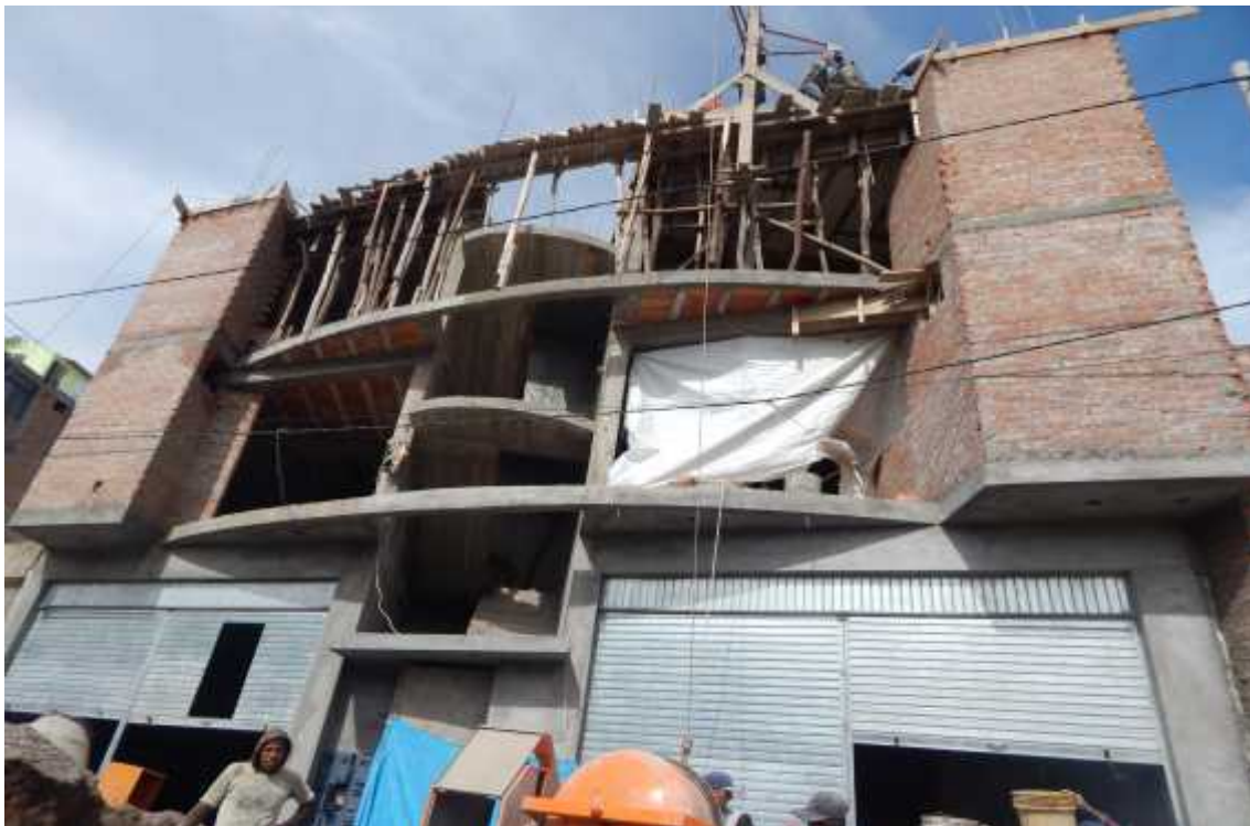
Foto 12: Vivienda N° 6, utilizando wincha para el transporte del concreto y sin uso de compactación
