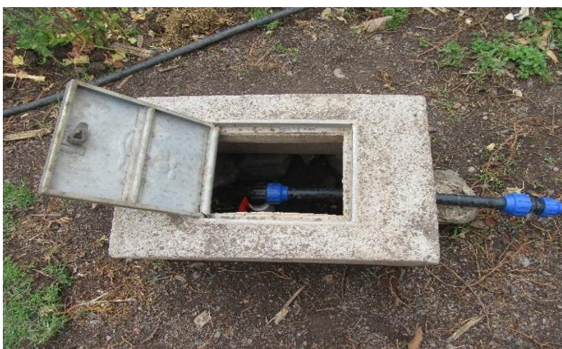
Figura 2.18. Actual (Hidrante de 1")
