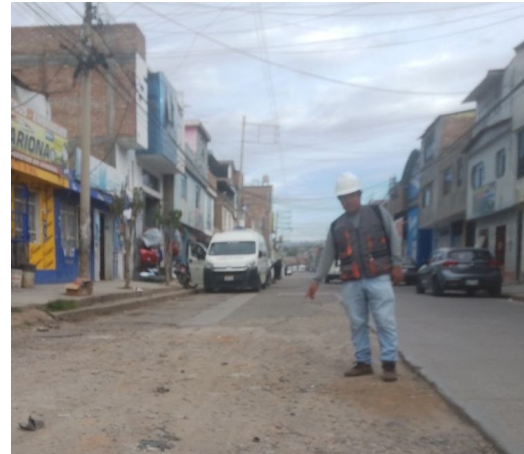
(b) Falta de mantenimiento en la vía
