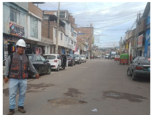
(b) Superficie de rodadura irregular
