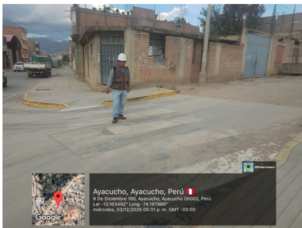
(a) Paso peatonal con pintura desgastada
