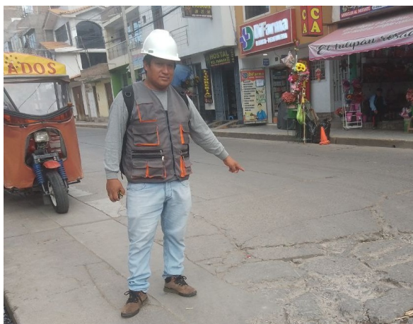
(a) Deterioro de pavimento
