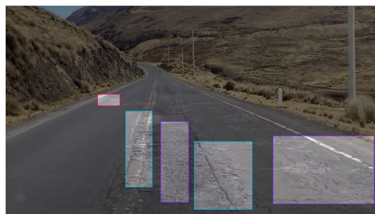
Figura 44 clasificacion de fallas tramo Socos Licapa
