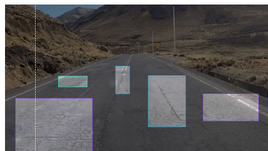
Figura 40 clasificacion de fallas tramo Socos Licapa
