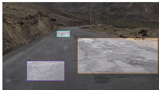
Figura 48 clasificacion de fallas tramo Socos Licapa
