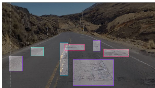
Figura 56 clasificacion de fallas tramo Socos Licapa
