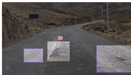
Figura 46 clasificacion de fallas tramo Socos Licapa
