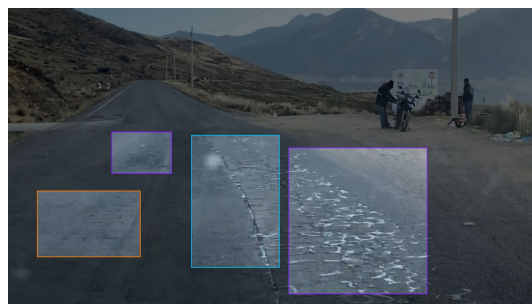
Figura 50 clasificacion de fallas tramo Socos Licapa
