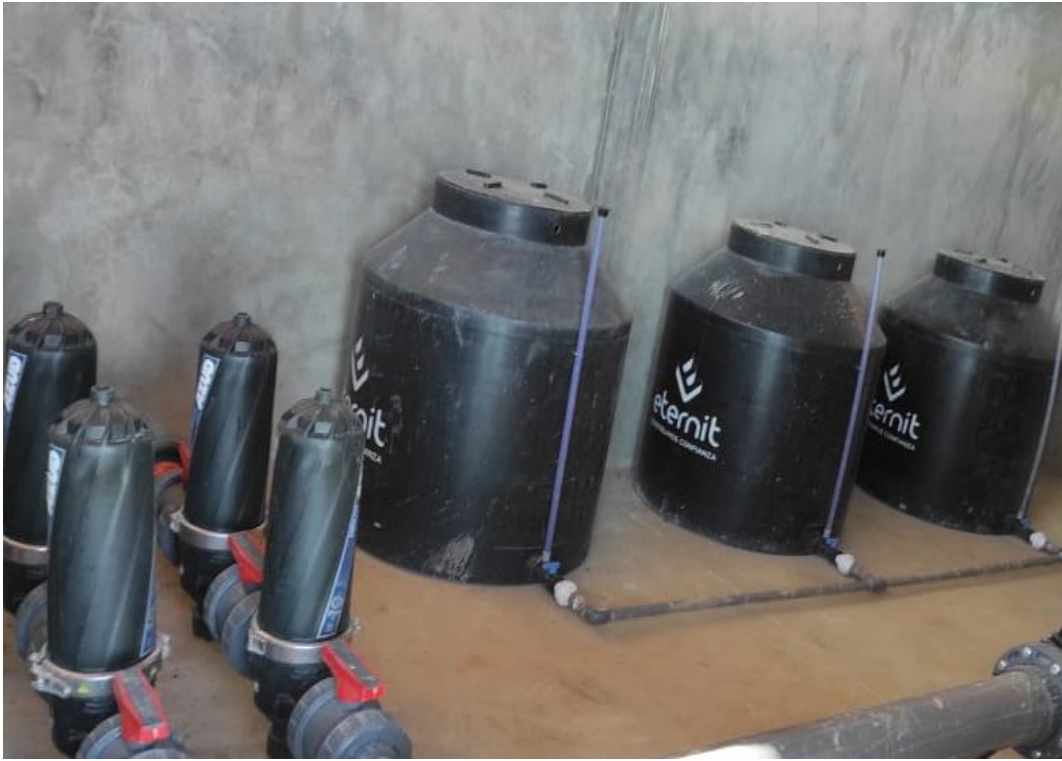
Fotografía 15: Cabezal del sistema de riego
