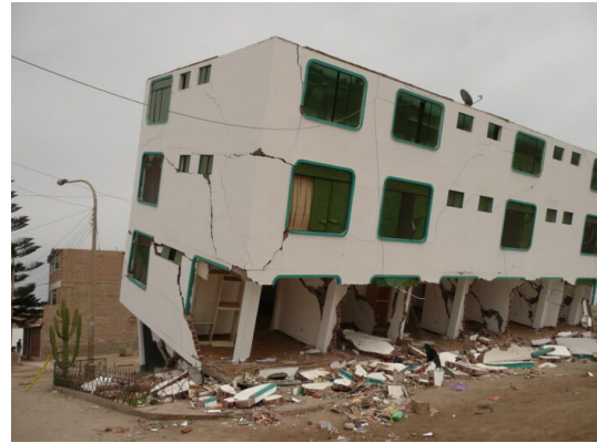
(b) Edificación colapsada producto del terremoto de pisco del 2007
