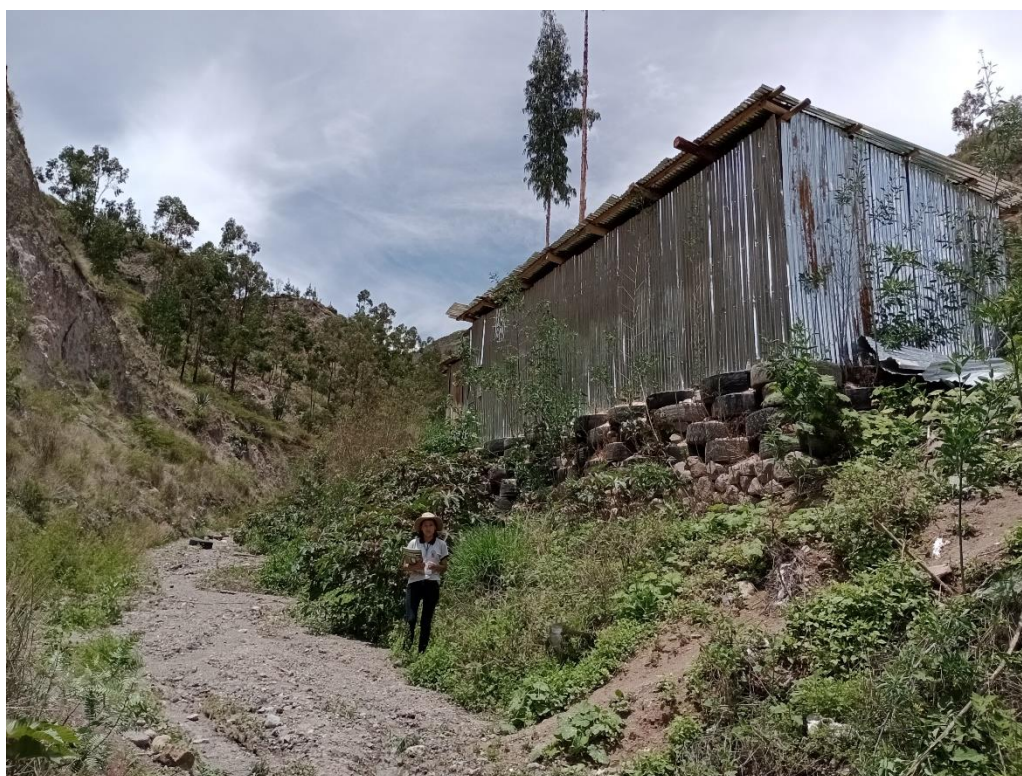
Figura D.3. Muestra que la plataforma que sostiene a la vivienda está hecha a base de piedras y llantas lo que no brinda la seguridad necesaria ante la ocurrencia de un peligro por flujo de detritos.
