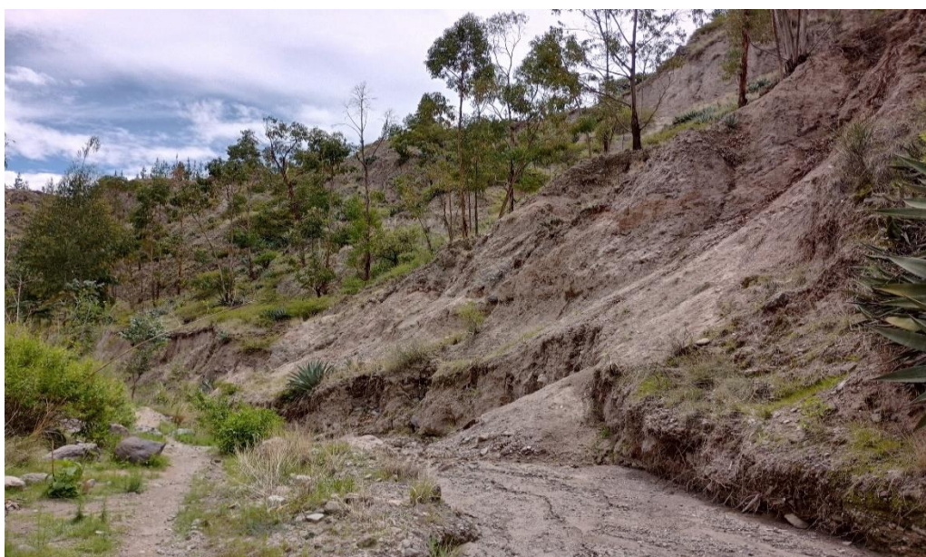
Figura D.4. Suelo inestable que a causa del agua que fluye por la quebrada está siendo socavada.
