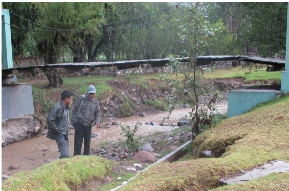
Figura 2.4: Ubicación de la bocatoma
