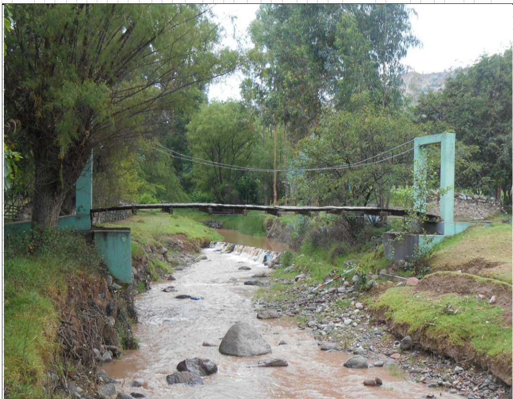
FOTOGRAFÍA N° 02: Toma lateral del río Pacaycasa de forma artesanal (mes marzo )
