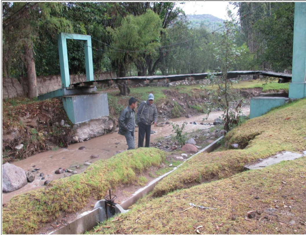
FOTOGRAFÍA N° 01: Identificación de la toma lateral del río Pacaycasa y la línea de conducción
