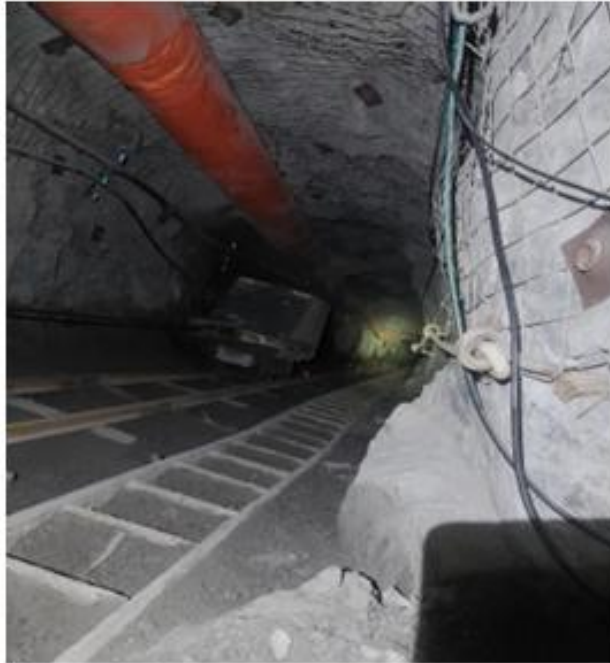
Figura 45. Manga de ventilación.
