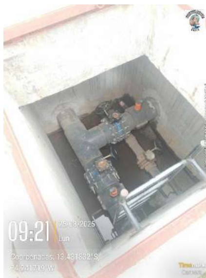
Figura 51. Cámara de válvulas de derivación en pozo.
