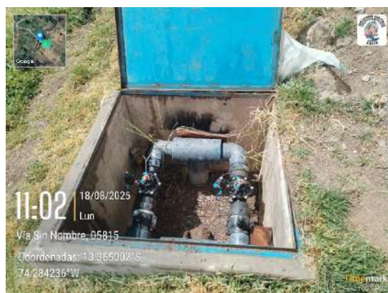
Figura 39. Válvula sectorial automatizada en Manzanayocc.
