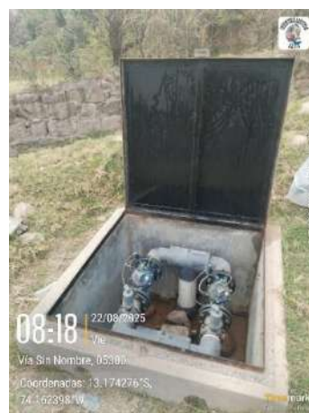
Figura 45. Válvula sectorial automatizada en Santa Bárbara.
