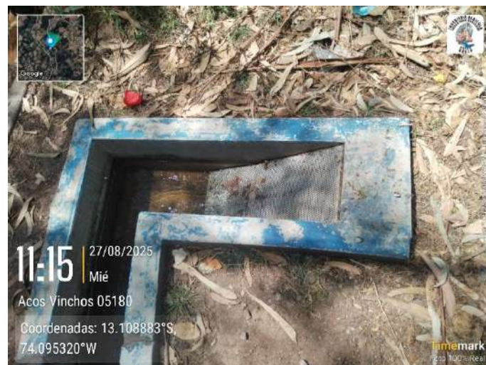
Figura 56. Rendijas en el sistema para evitar obstrucciones.
