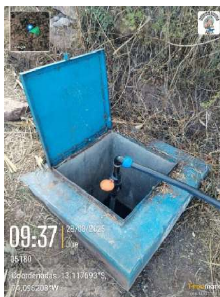
Figura 58. Cámara de hidrante parcelario.
