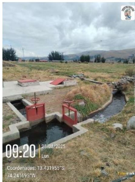
Figura 50. Compuertas de derivación.
