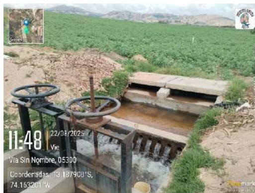
Figura 43. Estructura de Desarenador.
