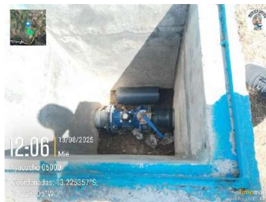
Figura 31. Cámara de válvula sectorial en Casaorcco.
