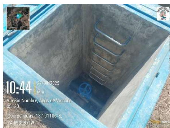
Figura 54. Cámara de válvula de derivación al sistema.
