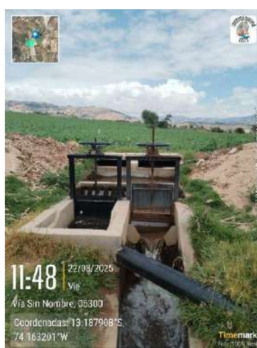
Figura 44. Compuerta de alimentación para reservorio.
