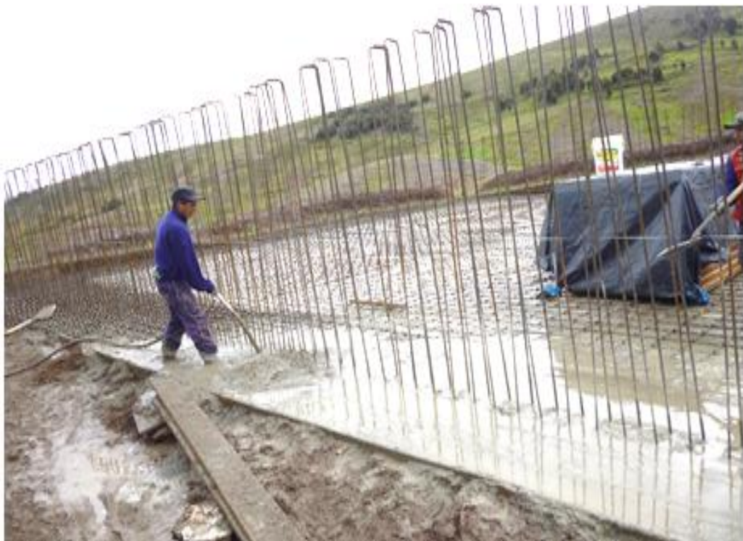
Desperdicio de concreto armado en el vaciado de zapata reservorio Larampuquio
