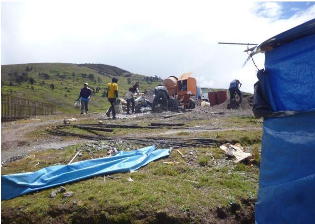
Desperdicio real de acero
