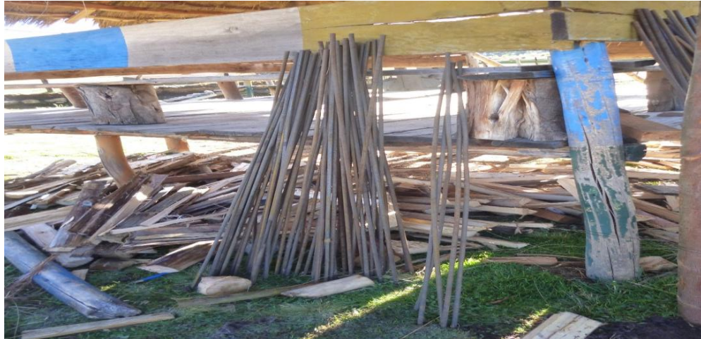
Figura Nº 20. Desperdicio de acero – reservorio Erusco
