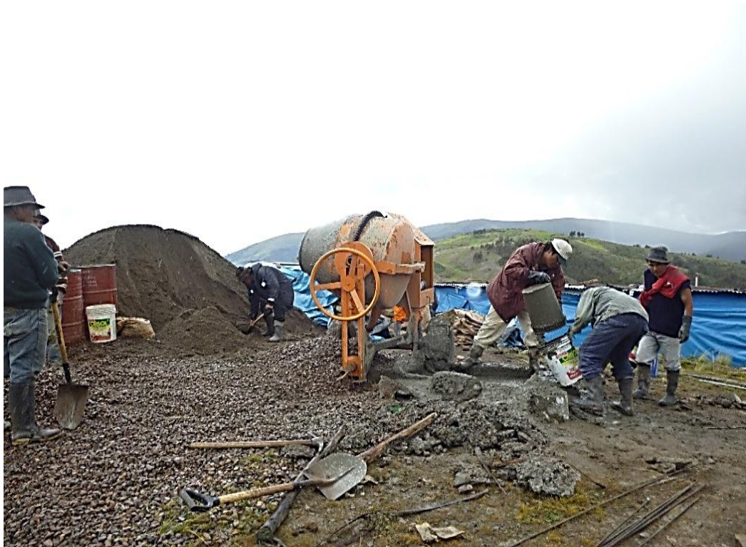
Desperdicio de concreto a la hora del traslado
