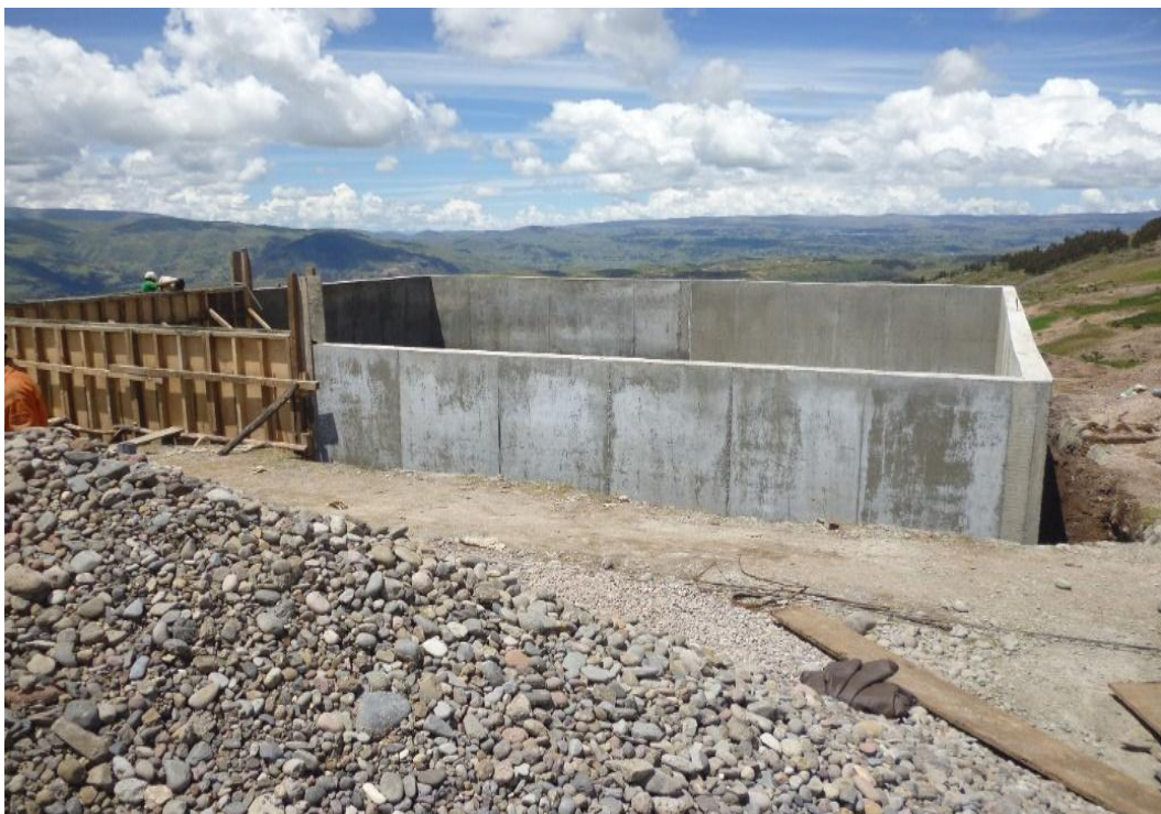
Desperdicio real de hormigón
