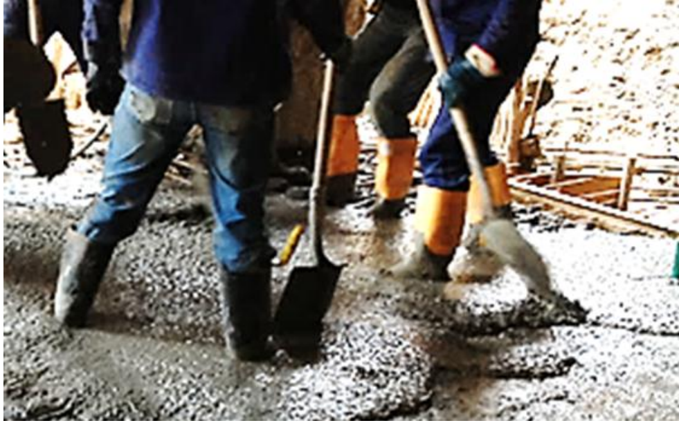
Figura N° 17. Desperdicio de concreto al momento del vaciado
