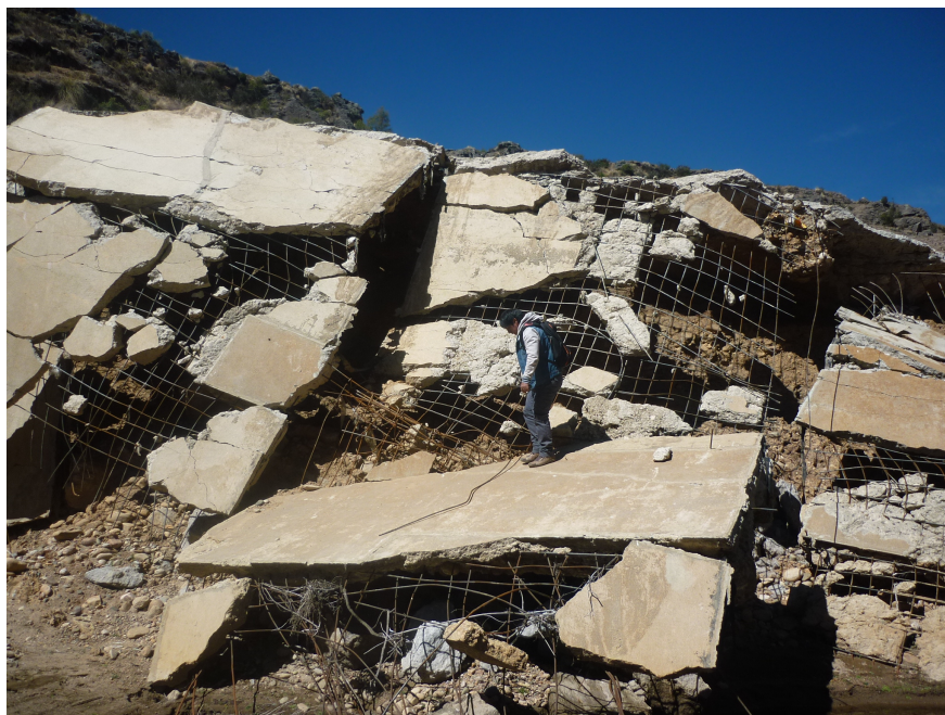
Figura 4.14: Vista de los restos de la pantalla impermeable.
