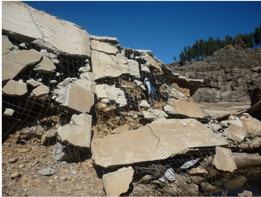
Figura 3.21: Sección de falla de la presa Tomacucho.
