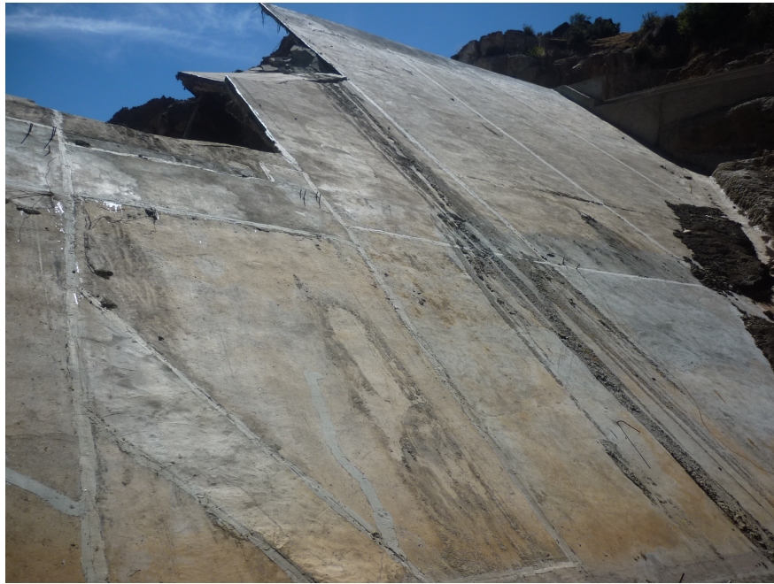
Figura 4.15: Vista de las fisuras en la pantalla impermeable.
