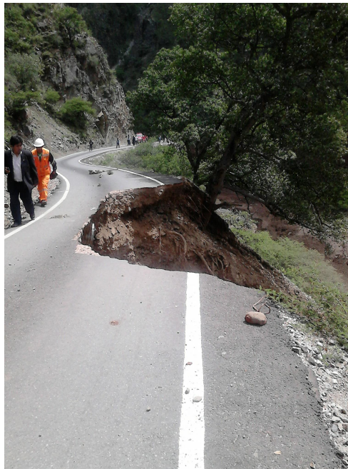
Figura A.13: Colapso de pavimento económico en la carretera puente Cayhua - Chonta - Querobamba.
