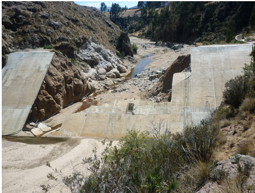
Figura A.1: Vista del rompimiento de la presa TOMACUCHO.
