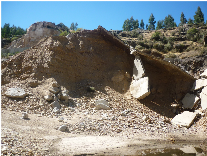
Figura A.3: Restos del cuerpo de la presa TOMACUCHO. Fuente: Elaboración propia.
