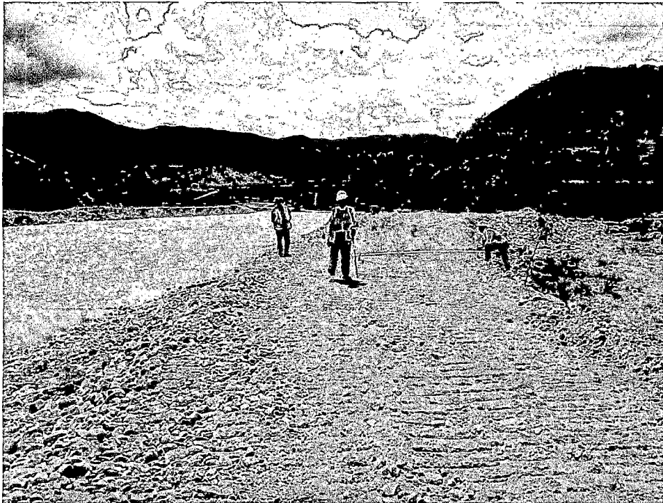
Fig. N° 17. Medición de las secciones del movimiento de tierra realizado por el tractor sobre orugas Shantui en el proyecto “Encauzamiento y Descolmatación del río Pongora”
