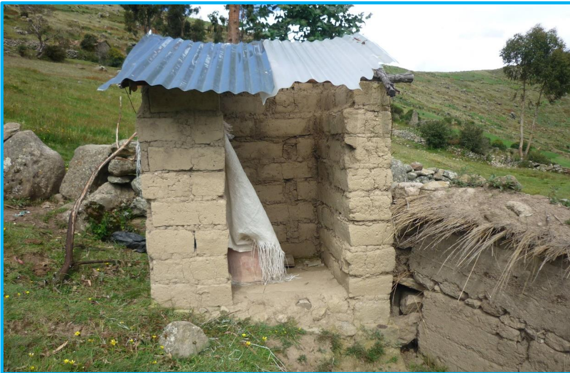
FOTO Nº 04: LETRINAS ARTESANALES EN ESTADO DEPLORABLE
