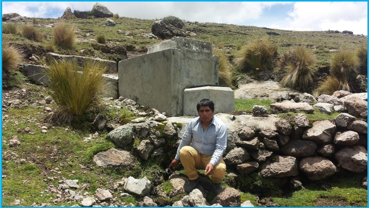
FOTO N° 05: VERIFICACIÓN DE LA CAPTACIÓN MILLPO, EN ESTADO DEPLORABLE
