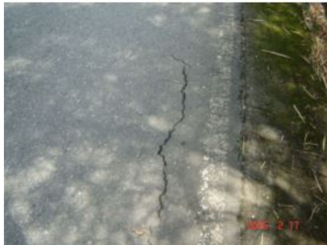
Fisuras de borde
