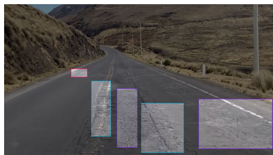
Figura 44 clasificacion de fallas tramo Socos Licapa
