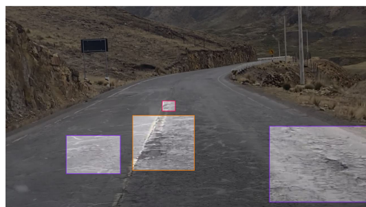
Figura 46 clasificacion de fallas tramo Socos Licapa
