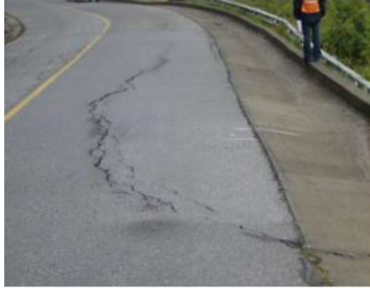
Fisuras en media luna
