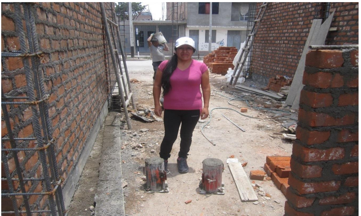
Fotografía 17: toma de muestra de columna de vivienda número 11, preparación de mezcla en cilindros, traslado con baldes.
