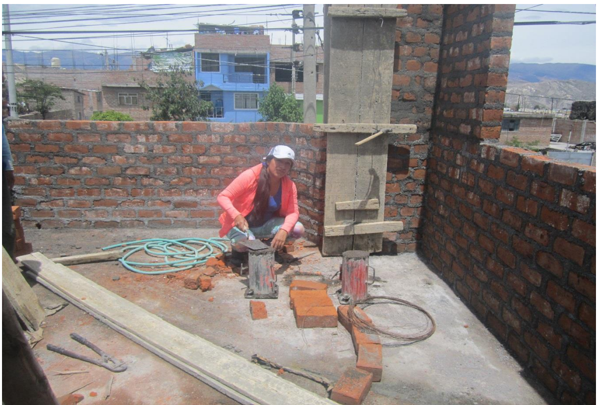
Fotografía 27: toma de muestra de columna vivienda número 18, preparado de mezcla en cilindros, traslado en baldes
