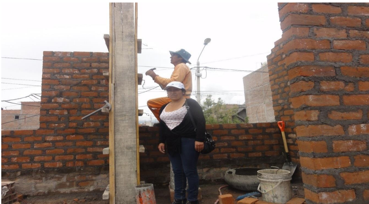
Fotografía 13: toma de muestra columna de vivienda número 07, preparado de mezcla en cilindro, traslado con baldes.
