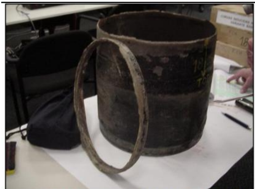
Imagen 11: Vista de la sección afectada. La falla de tubería se presentó en la totalidad de la circunferencia.
