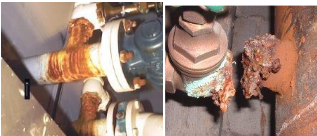
Figura 2.15. Corrosión galvánica (Carrasco, 2008)
