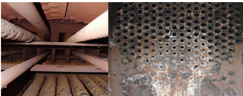
Figura 2.14. Corrosión por oxígeno (Carrasco, 2008)
