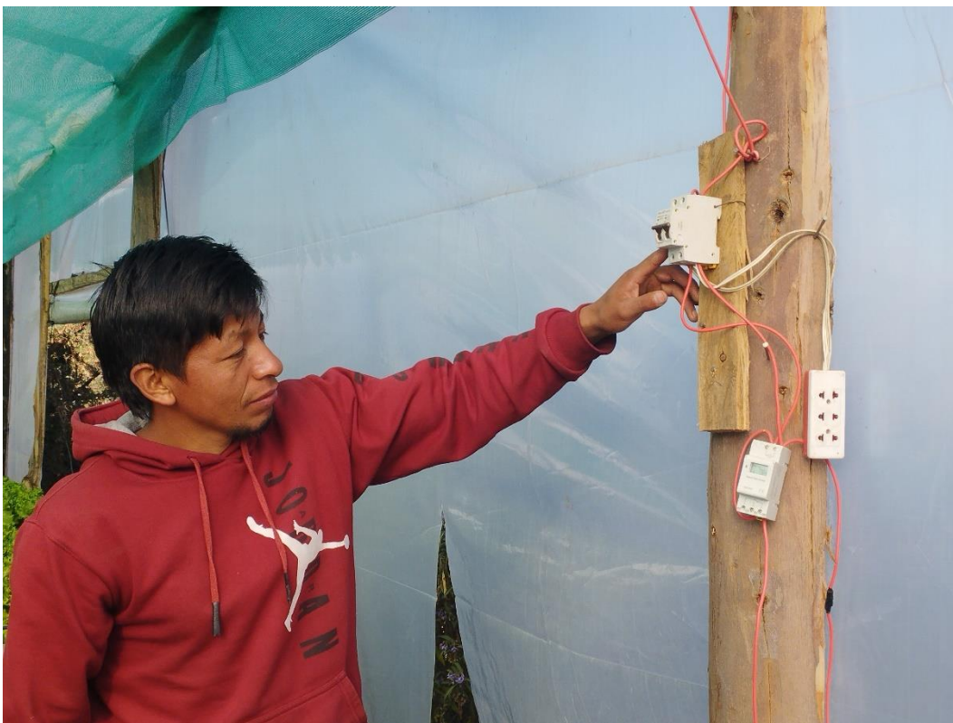
Ilustración 5. Instalación eléctrica y el temporizador.
