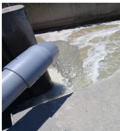
Figura 67. Calidad de agua residual a la salida OVERFLOW del hidrociclón.
