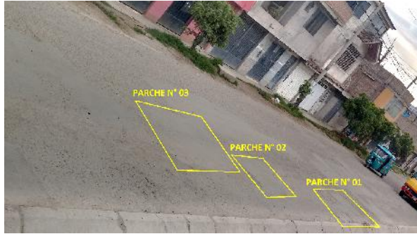
Identificación de parchado de baches en la Av. Javier Pérez de Cuellar, cuadra 8
