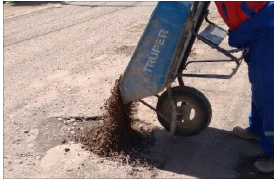
En el procedimiento de "bacheo" de la MPH no existe remoción de las zonas afectadas Fuente: Elaboración propia
