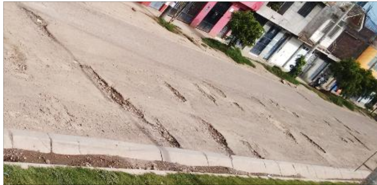
Condición de la Av. Javier Pérez de Cuellar (cuadra N° 8), antes del mantenimiento.
