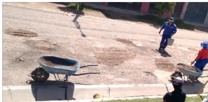
Baches sin delimitación paralela ni perpendicular a la vía de 0.3m sobre la superficie circundante para corte.
