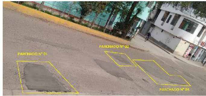
Identificación de parchado de baches en la Av. Javier Pérez de cuellar, Cuadra 9
