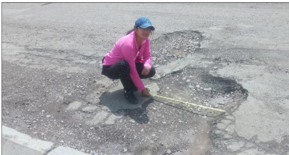
Medida del área de bache en la Av. Javier Pérez de Cuellar antes del mantenimiento
