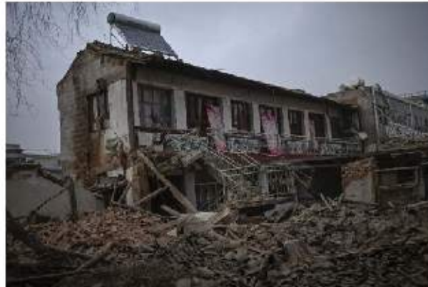
Fig. 6 Edificios y casas devastados en China.
