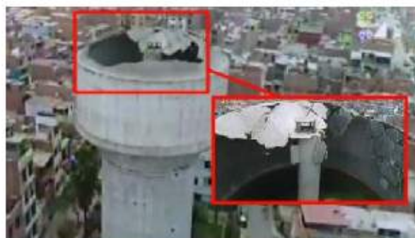
Fig. 12 Tanque elevado con fuste deteriorado (Callo - Lima).
