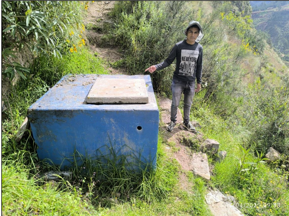
Imagen 11: Cámara Rompe Presión Existente del Sector Lliplina -CDC
