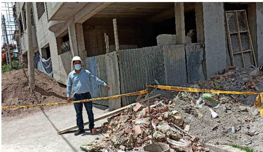
Figura 16 Vista fotográfica de residuos de la construcción en edificación. Fuente: Elaboración propia
