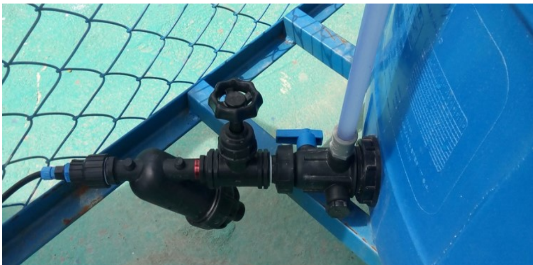
Figura 8. Sistema de cloración por goteo autocompensante: tanque de solución madre conectado a componentes de salida.
