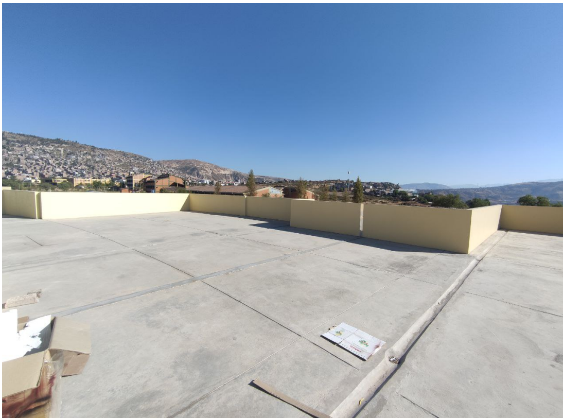
Figura B.18 Junta sísmica que continua en el techo
