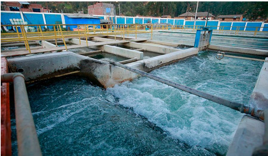
Planta de tratamiento de agua potable
