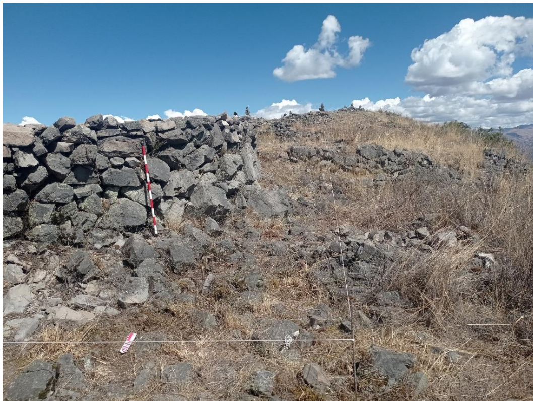
Figura 63. Lado posterior oeste en la capa "S", se observa gran cantidad de maleza y piedras colapsadas, Fuente: PIA Tinyacc.
