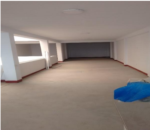
Figura N°03: Estado del interior del tercer piso de la planta de procesamiento LADA INVERSIONES EIRL - 2019
