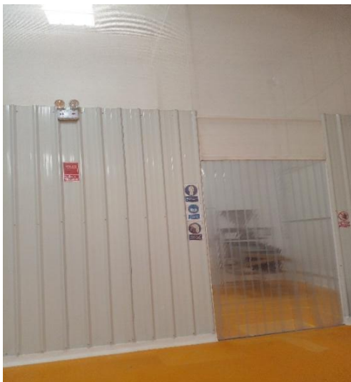
Figura N°15: Estado de mejora en las divisiones de áreas (pintado, luces de emergencia, señaléticas, cortina sanitaria), en el interior de la planta de procesamiento LADA INVERSIONES EIRL - 2020
