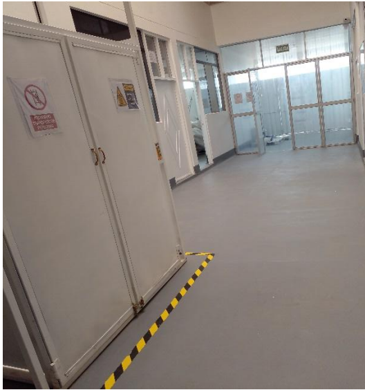
Figura N°13: Estado de mejora (pintado, delimitación, señaléticas, cortina sanitaria), en el interior del primer piso de la planta de procesamiento LADA INVERSIONES EIRL - 2020
