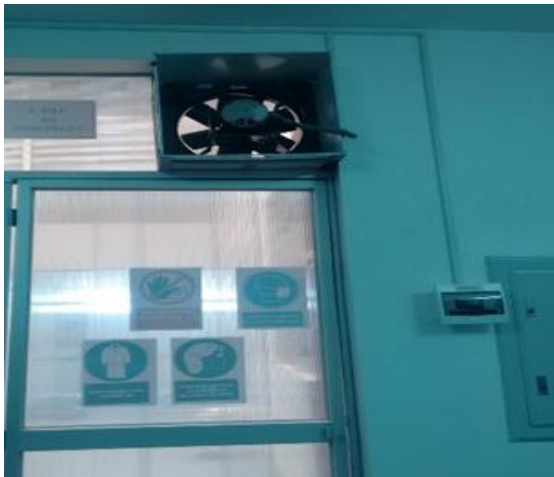
Figura N° 09: Ambientes que cuentan con extractores.
