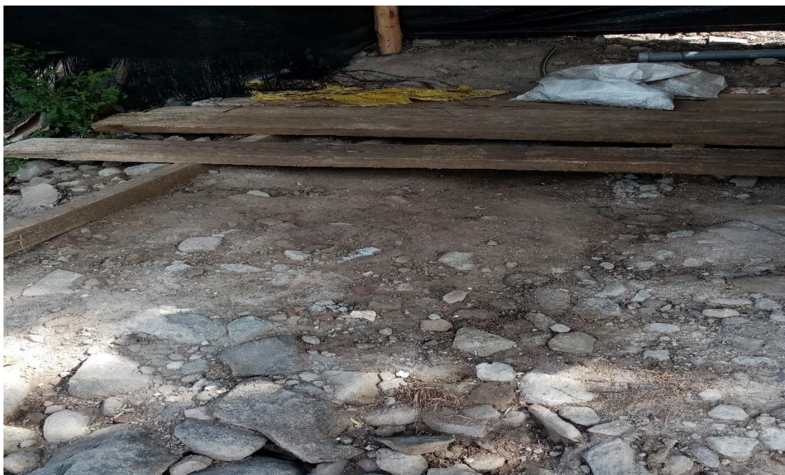
Fotografía 5: Contaminación del suelo por derrame de combustible
