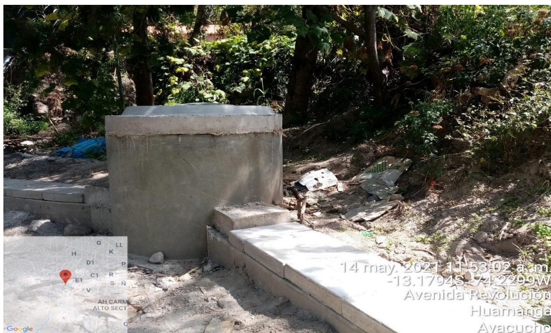
Fotografía 8: Residuos sólidos como bolsas de cemento y plásticos dejados a lo largo de la red de desagüe ejecutada en la obra de saneamiento.
