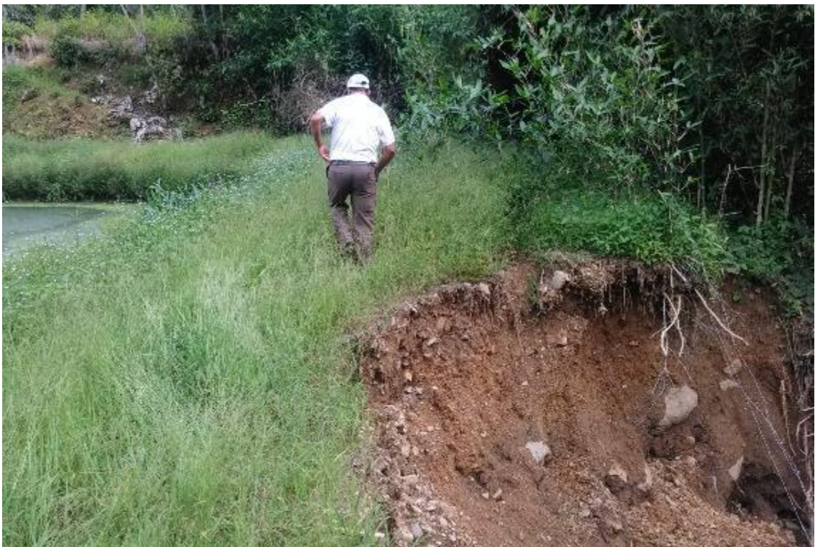
Imagen 8 Deslizamiento del talud exterior de la laguna por la socavación del río, noviembre 2019
