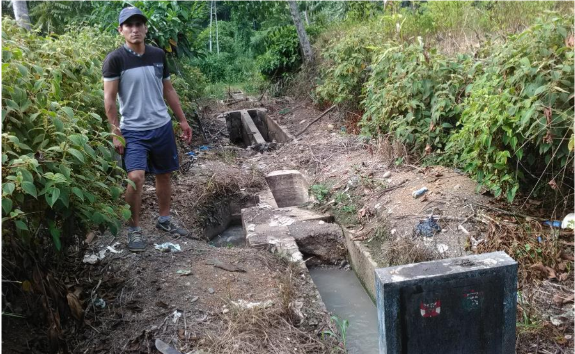
Imagen 1 Vista de cámara de rejas obstruido por los sedimentos de escorrentía pluvial
