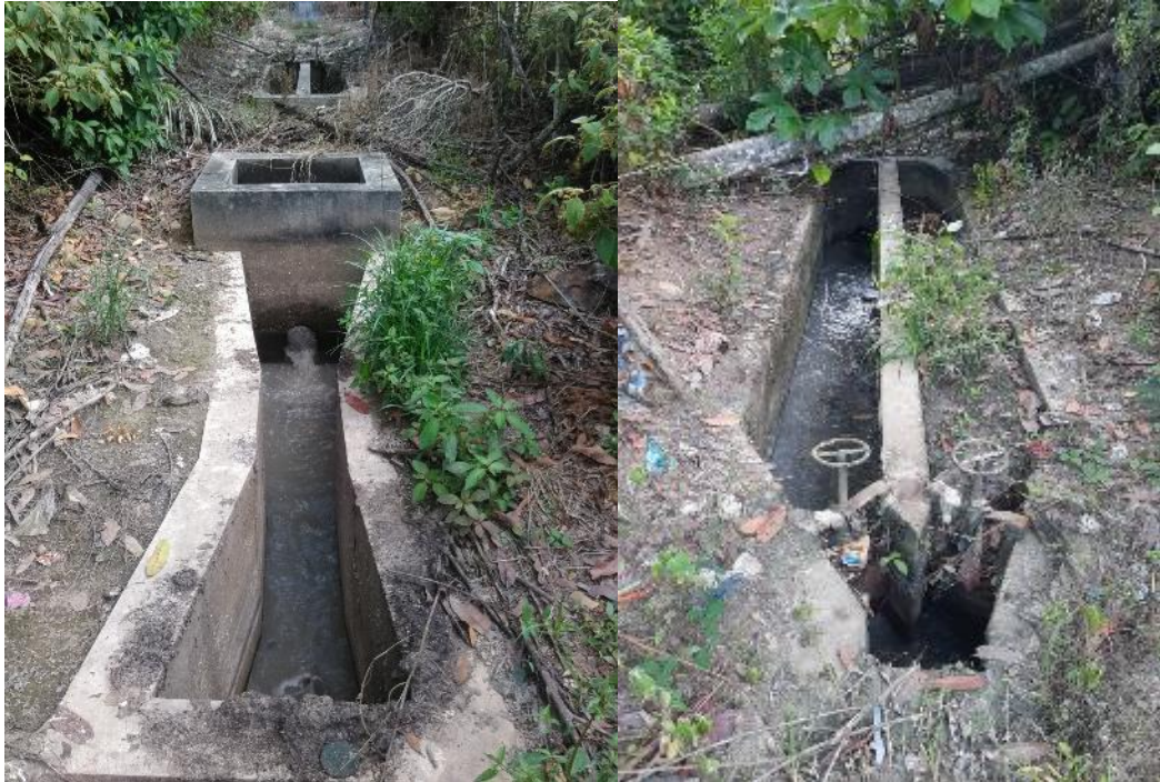
Imagen 3 Vista de medidor parshall mal construido y desarenador sin limpieza.
