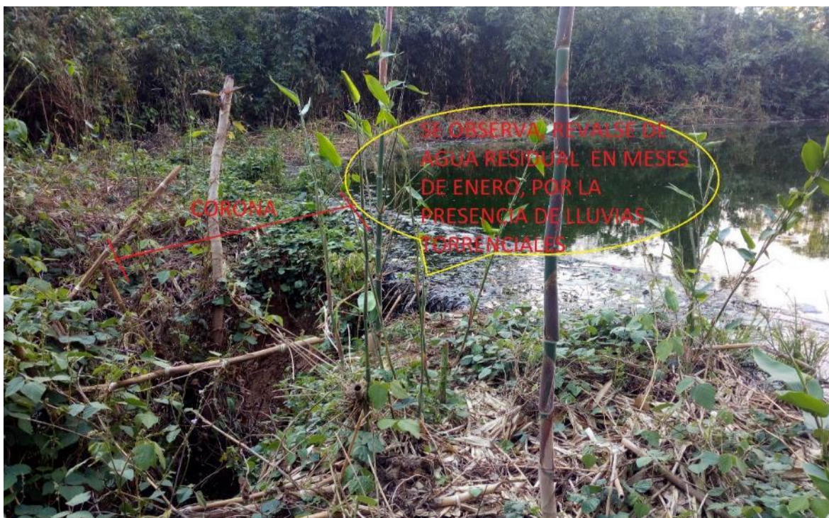
Figura 2.3 Vista de agua residual rebalsando por encima de la corona
