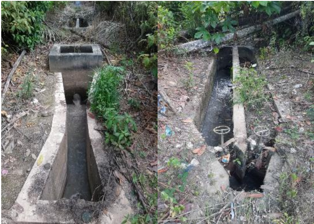
Imagen 3. Vista de medidor Parshall mal construido y desarenador sin limpieza
