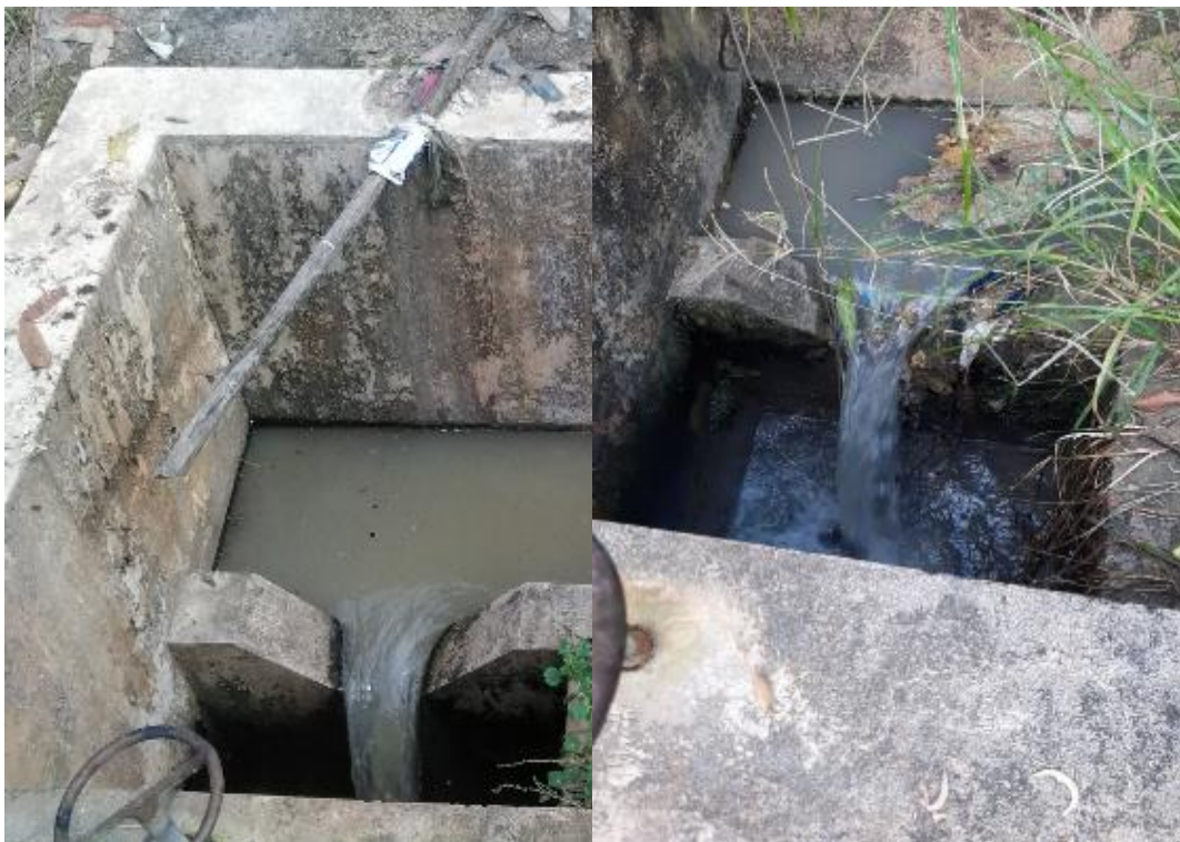
Imagen 4. Vista del vertedero en diferentes tiempos, donde se midió el caudal de aforo
