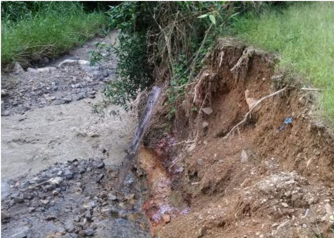
Imagen 7. Filtración del agua residual hacia el riachuelo por la corona socavado
