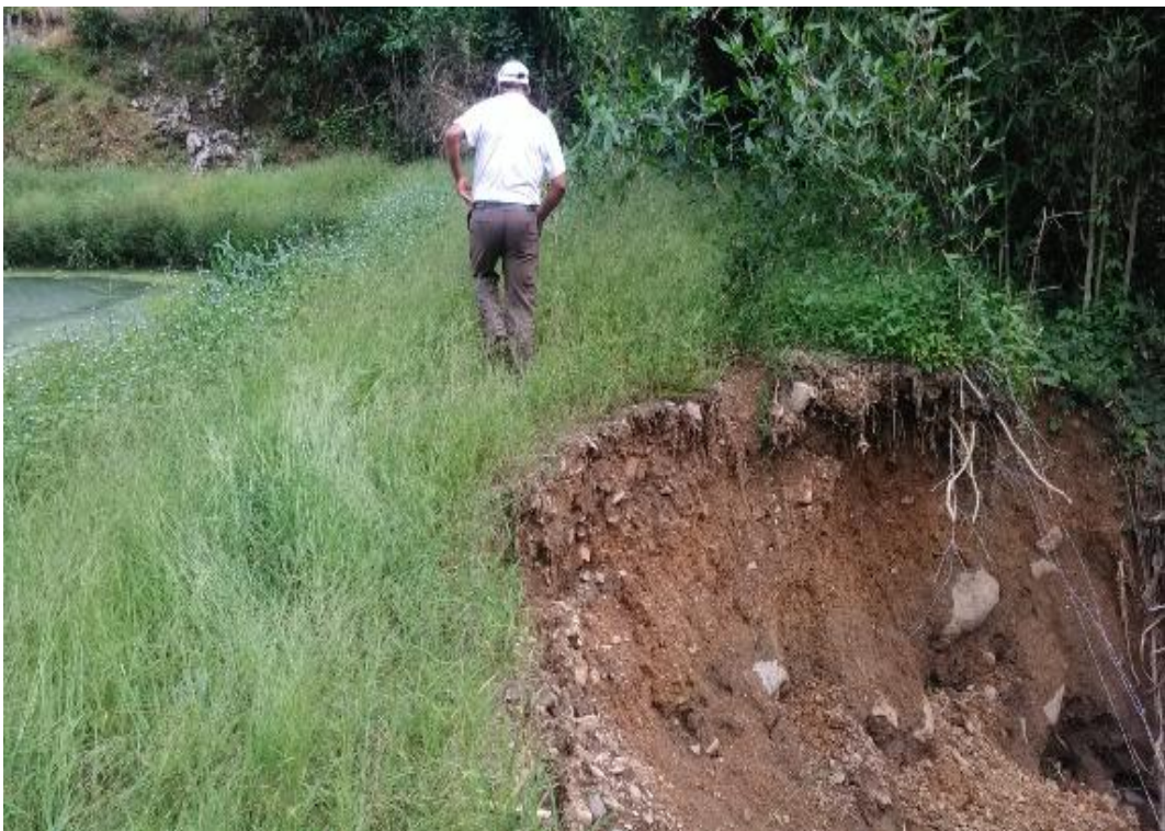
Imagen 8. Deslizamiento del talud exterior de la laguna por la socavación del río, nov-2019
