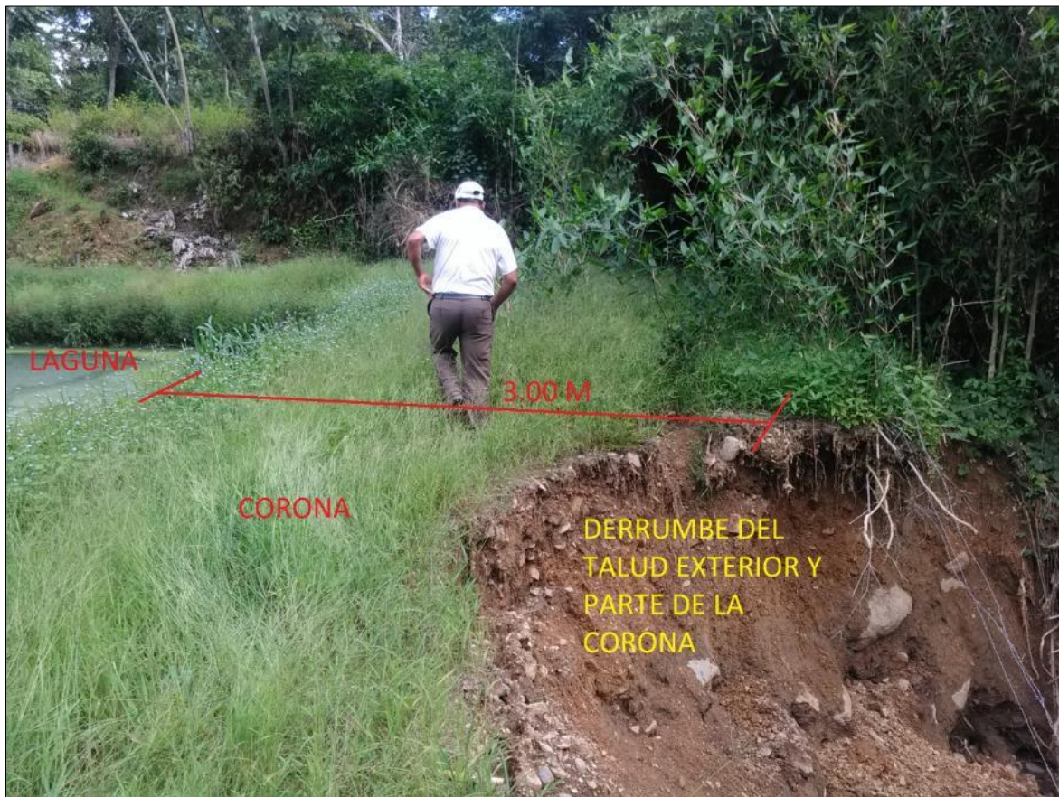
Figura 2.1 Vista del derrumbe provocado en el mes de noviembre del 2019.
