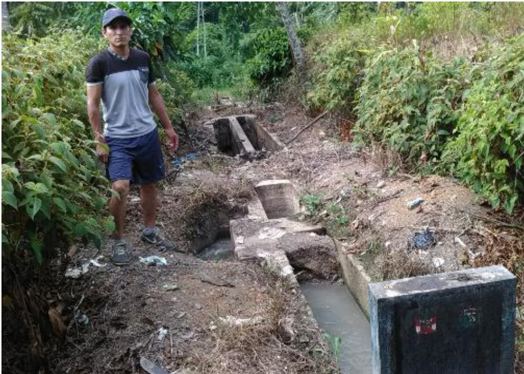
Imagen 1. Vista de cámara de rejillas obstruido por los sedimentos de escorrentía pluvial
