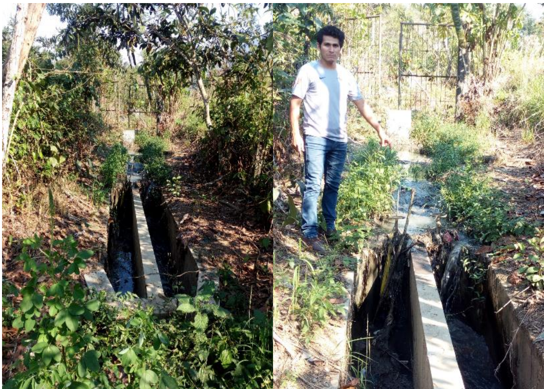
Imagen 2. Desarenador existente sin mantenimiento por la escorrentía pluvial
