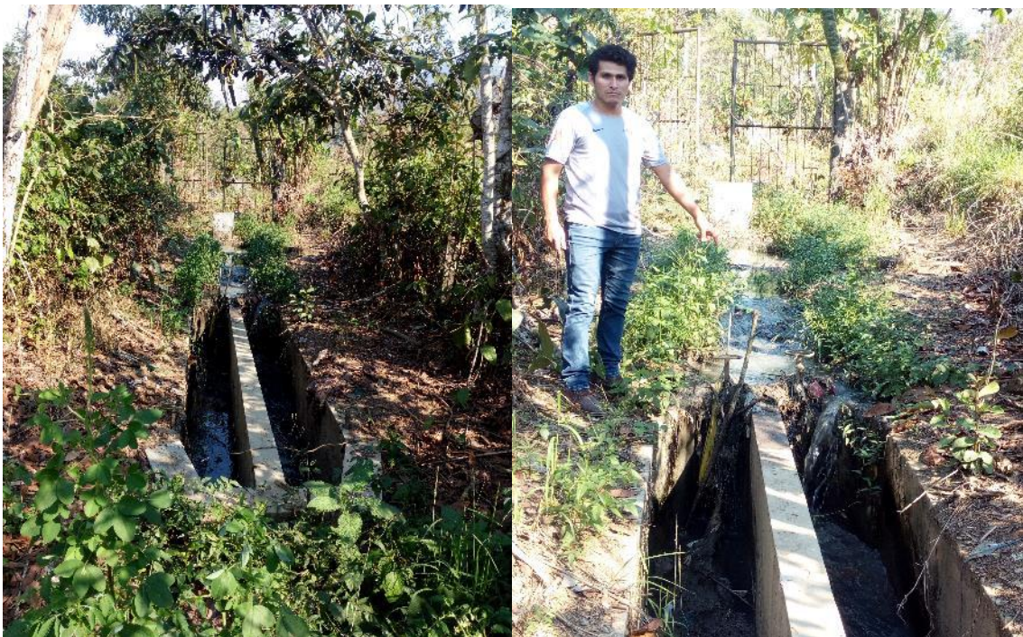
Imagen 2 Desarenador existente sin mantenimiento por la escorrentía pluvial
