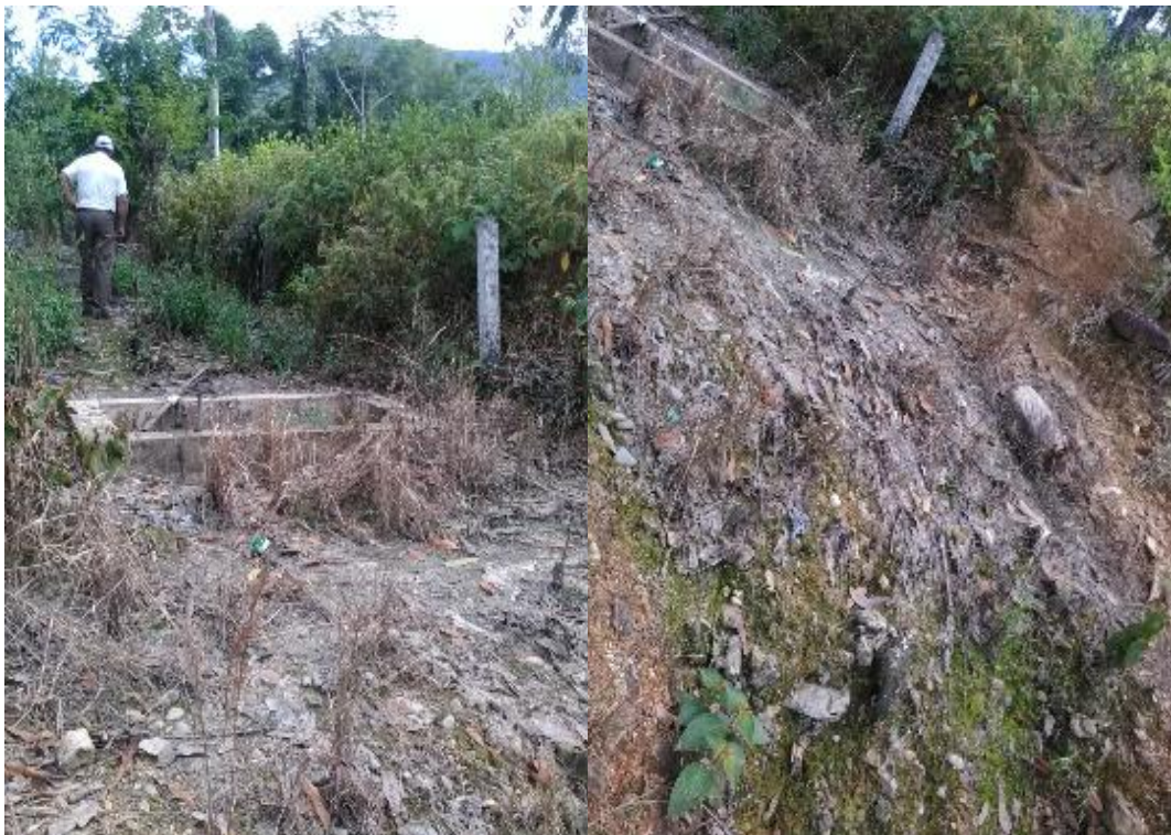
Imagen 10. Muestra de huellas del colapso del pretratamiento por las escorrentías, que van directo a la laguna de estabilización
