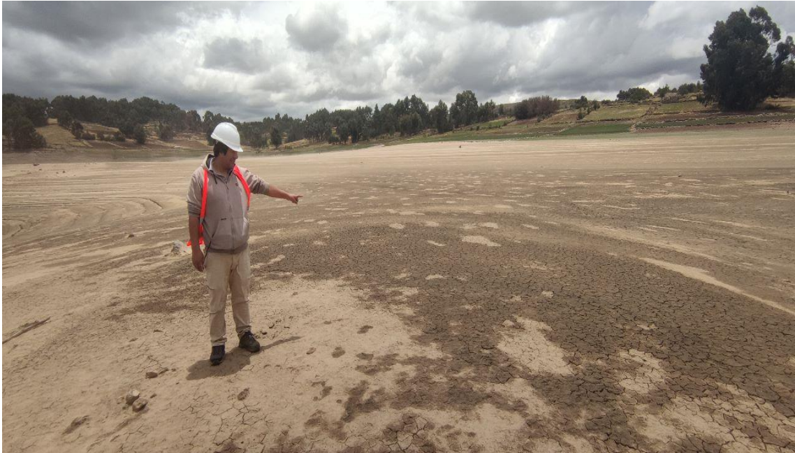
Figura 57 Sedimentación en el margen de la presa
