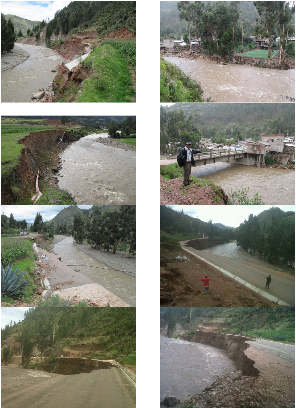
Figura N° 4.6: Algunas inundaciones producidas en la cuenca del río Vinchos por caudales extraordinarios.
