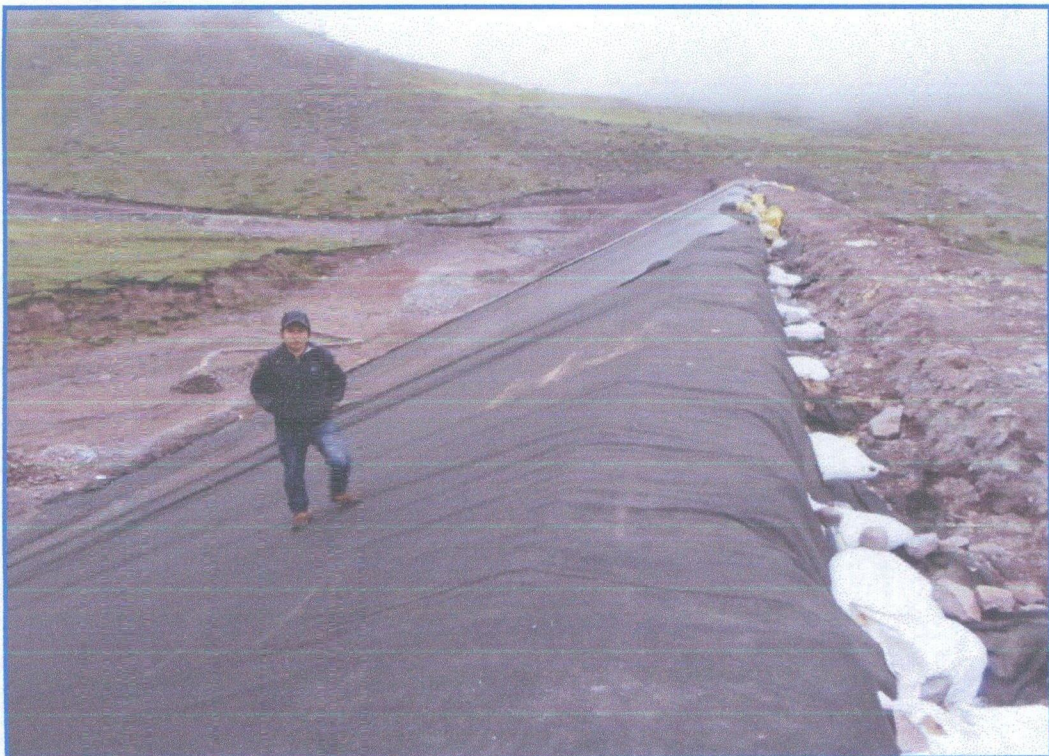
FOTOGRAFIA N° 08: Instalación de geotextil y geomembrana (PVC e=2mm ) talud aguas arriba de la presa.
