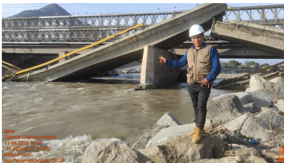
Fotografía 7. Evidencia de colapso de puente en la cuenca del río Chancay – Huaral
