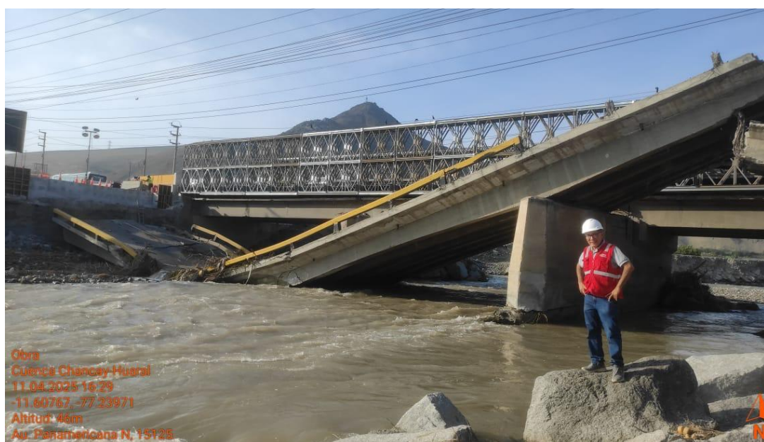
Fotografía 9. Daño estructural en puente vehicular colapsado sobre el río Chancay – Huaral
