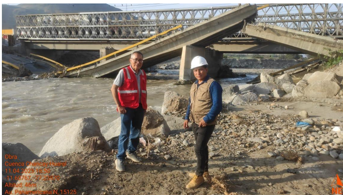
Fotografía 6. Inspección de daños estructurales en puente colapsado por crecida del río Chancay – Huaral
