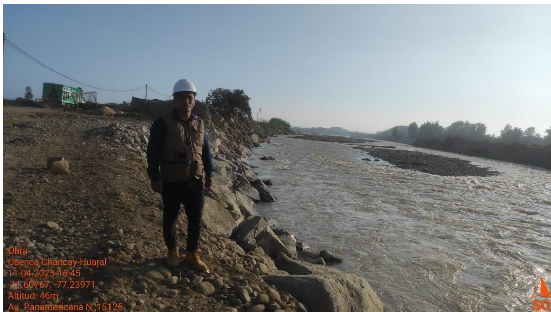
Fotografía 5. Evaluación visual de erosión en margen del río Chancay – Huaral
