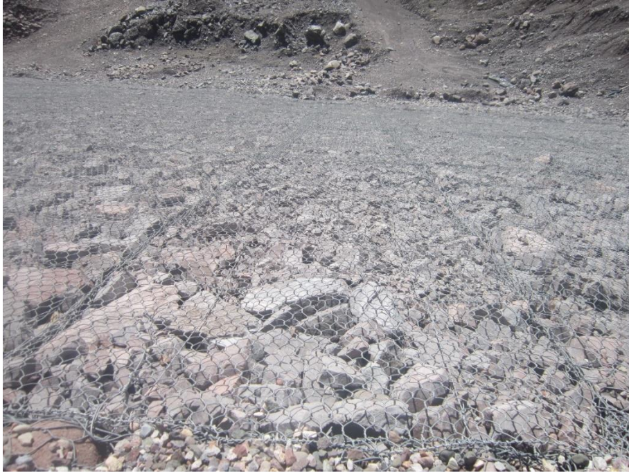
Figura Anexo 1- 23 enmallado de la parte interna de la represa
