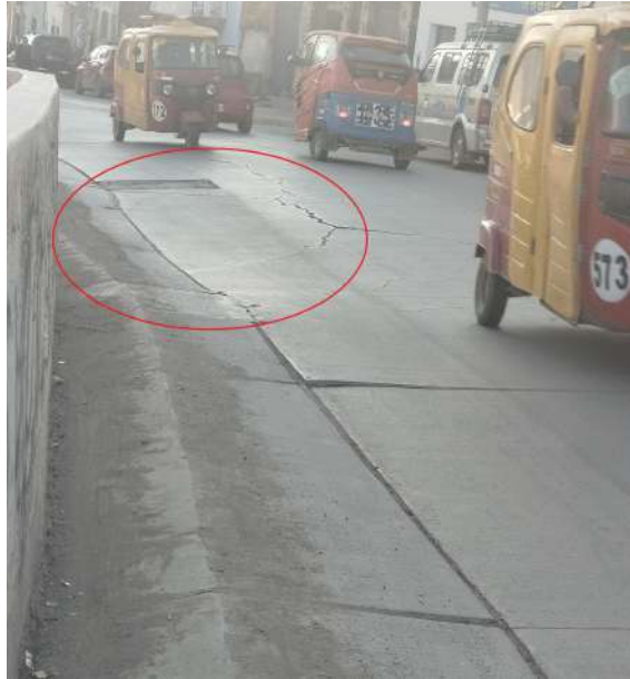
Figura 1.3: Claro hundimiento en pavimento reciente
