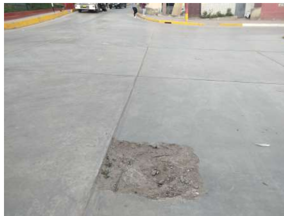
Figura 1.2: Desprendimiento de secciones del pavimento
