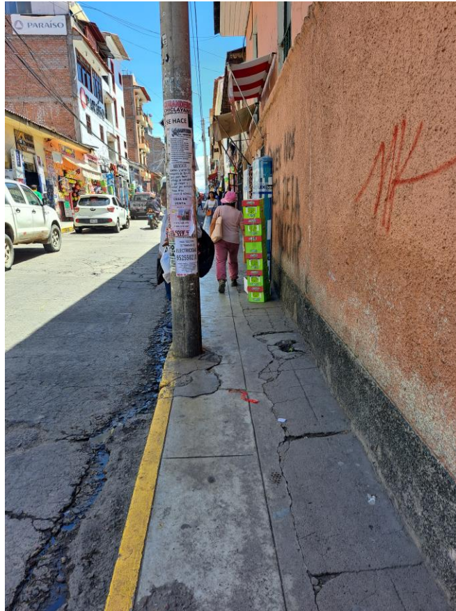
Figura 5. Barreras arquitectónicas en vereda.
