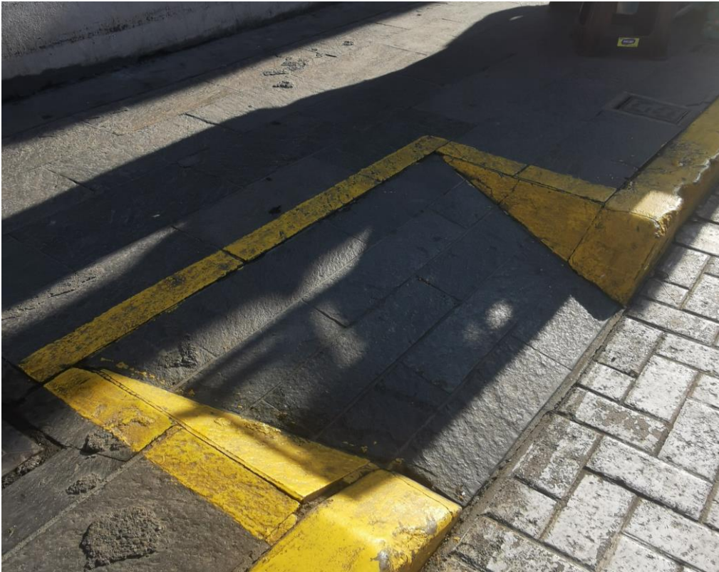
Figura 36. Rampa con pendiente inadecuada del Jr. Grau
