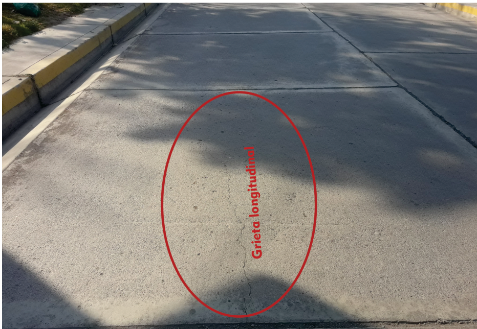
Figura 8 Agrietamiento longitudinal Jr. Los Rosales.
