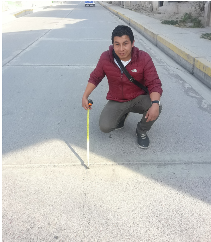
Figura 89 Agrietamiento longitudinal de losa Jr. Los Rosales
