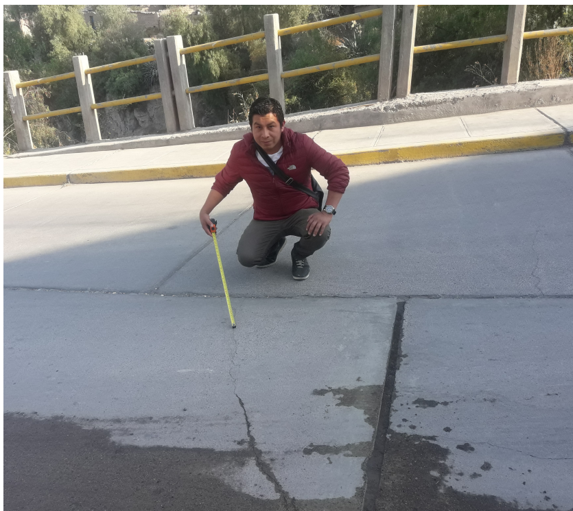
Figura 90 Agrietamiento en la esquina de losa Jr. Los Rosales
