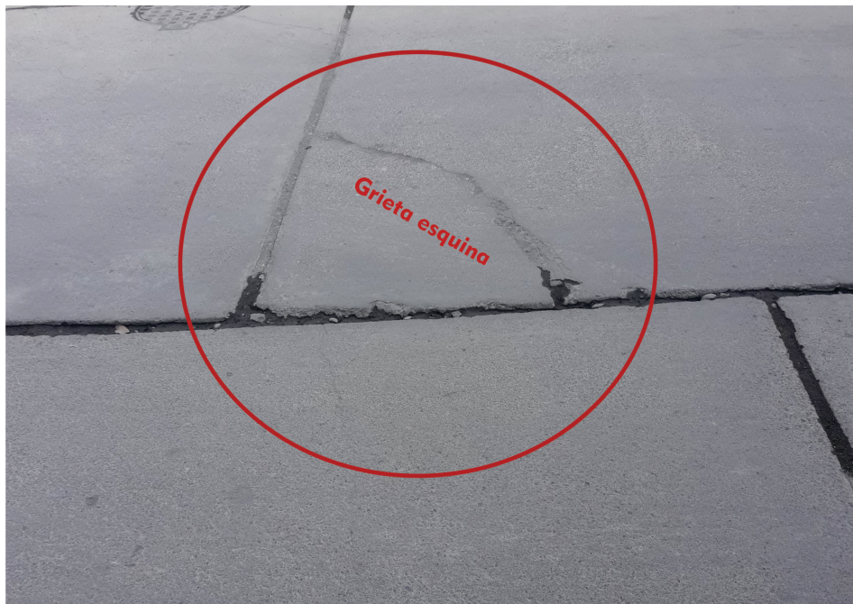
Figura 10 Agrietamiento esquina Jr. Los Rosales.
