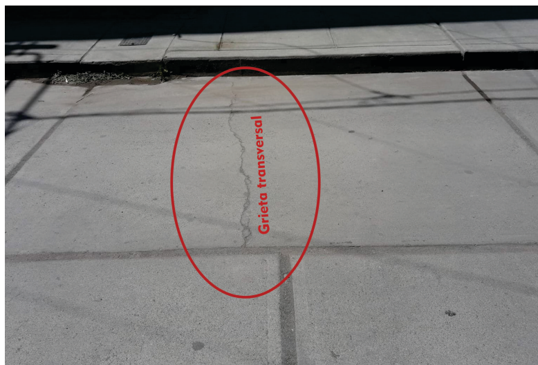
Figura 6 Agrietamiento transversal Jr. Los Rosales.
