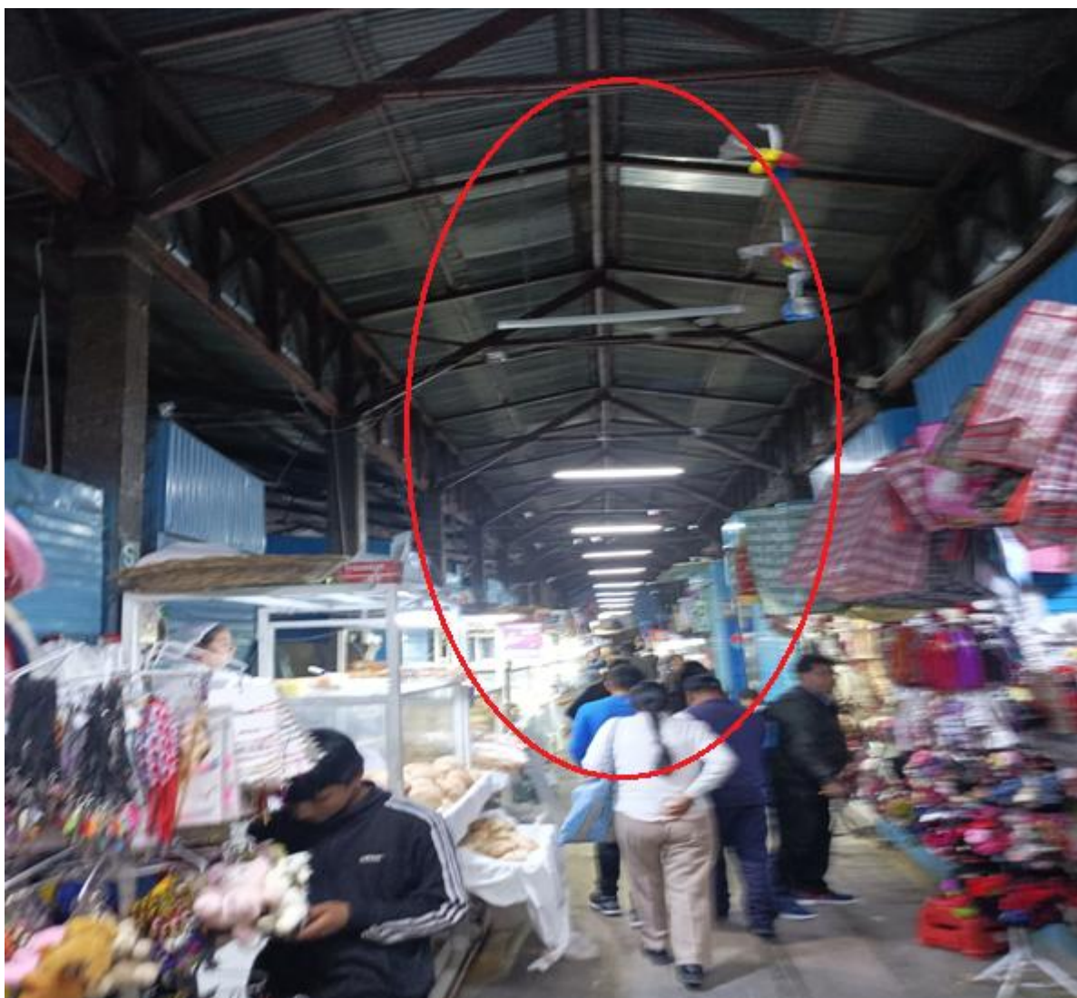
Foto 4: Situación actual del uso de Fluorescentes en los pasillos del mercado
