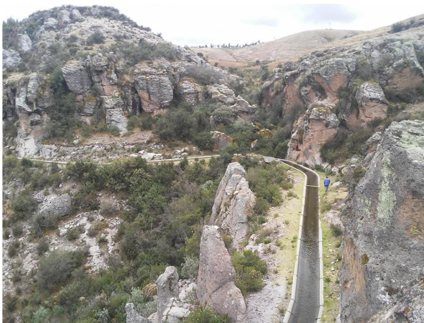
Figura 16: Canal Kacta, que parte de la bocatoma del mismo nombre (Raúl Rojas Martínez, 2024).
