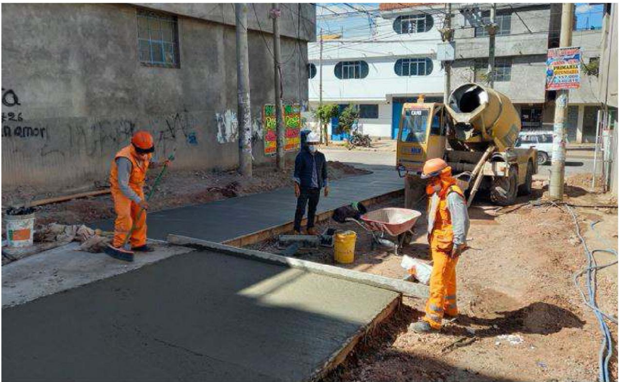
Figura B.4 Obtención de muestra para la elaboración de los testigos de concreto patrón, en la Primera cuadra del Jr. Pikimachay. Fuente: Elaboración propia
