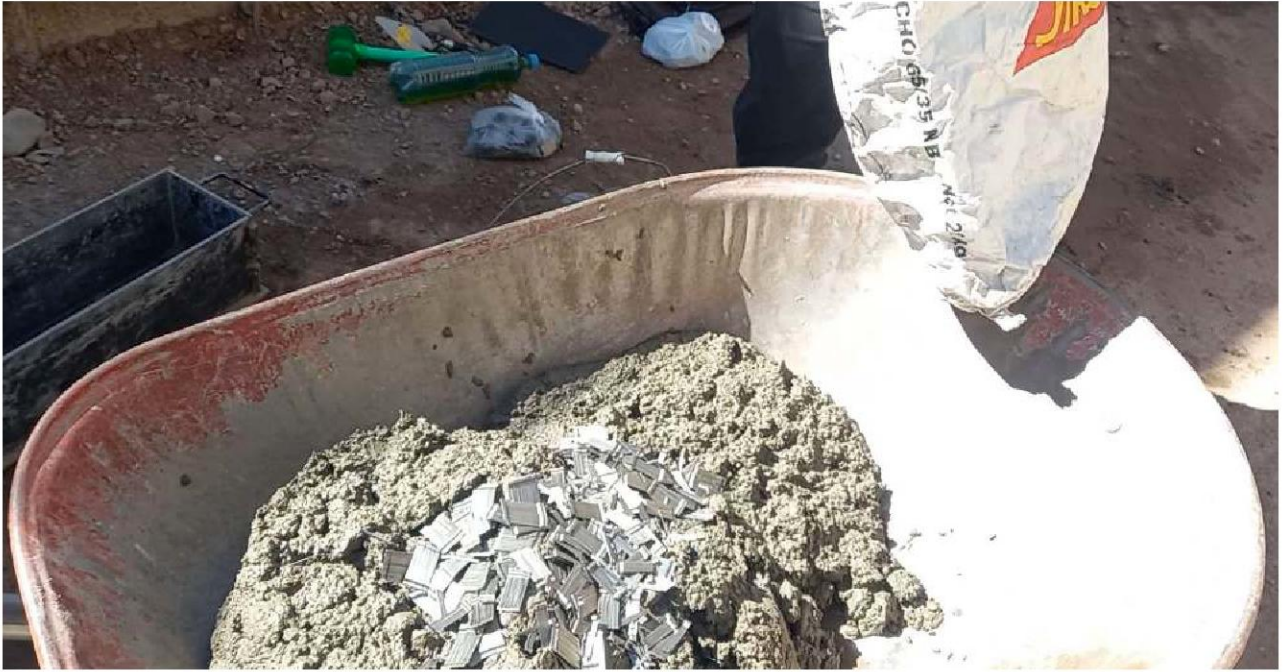
Figura B.5 Preparado del concreto adicionando fibras de acero en 5 % respecto al peso del cemento. Fuente: Elaboración propia
