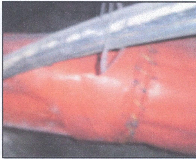
Fotografía 2.2: Empalme deficiente de un ducto a otro auxiliar.
