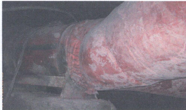
Fotografía 2.9: Accesorio en “Y” deficientemente confeccionado.
