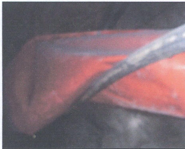
Fotografía 2.7: Bloqueo de la manga por una tubería.
