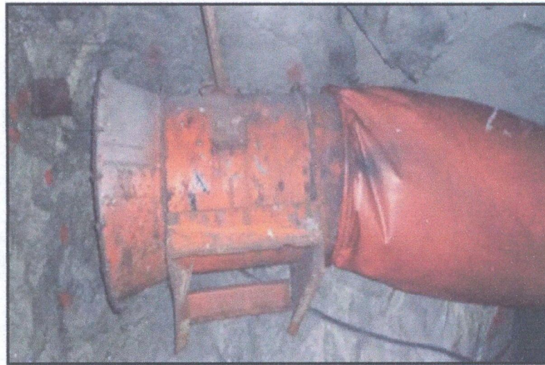
Fotografía 2.1: Acople ventilador/manga deficiente.
