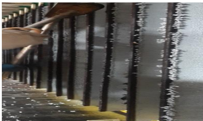
Figura 6.10: Cortocircuito por desalineamiento de bandeja Fuente: Propia
