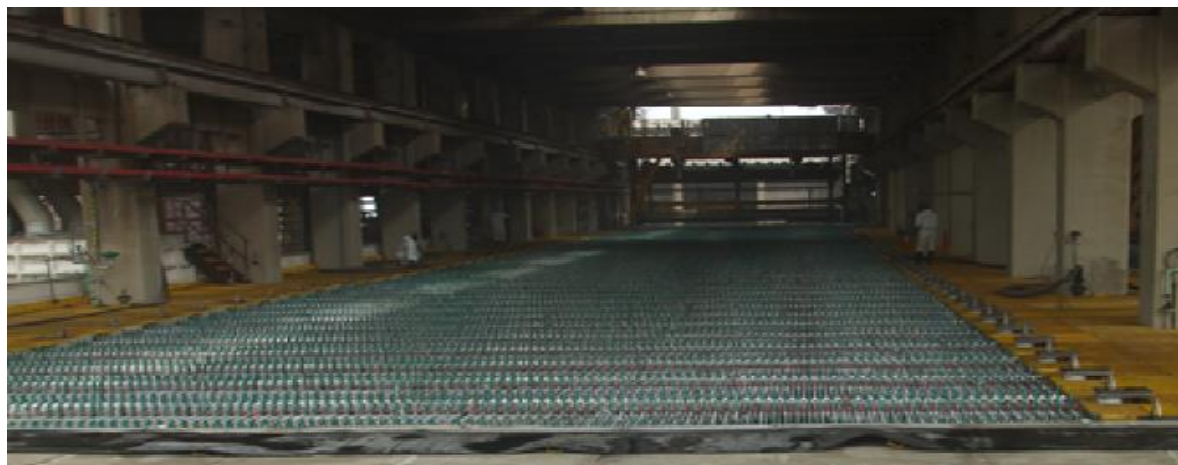
Figura 4.1: Planta de electrodeposición de zinc Refinería de Cajamarquilla Fuente: Propia
