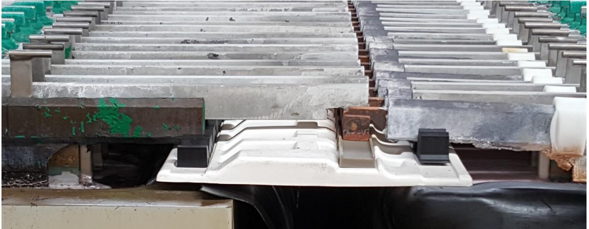
Figura 6.12: ubicación de bandeja entre celdas Fuente: Propia
