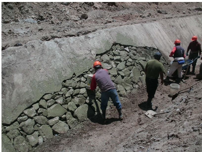
Figura 10 Erosión en la superficie de la estructura
