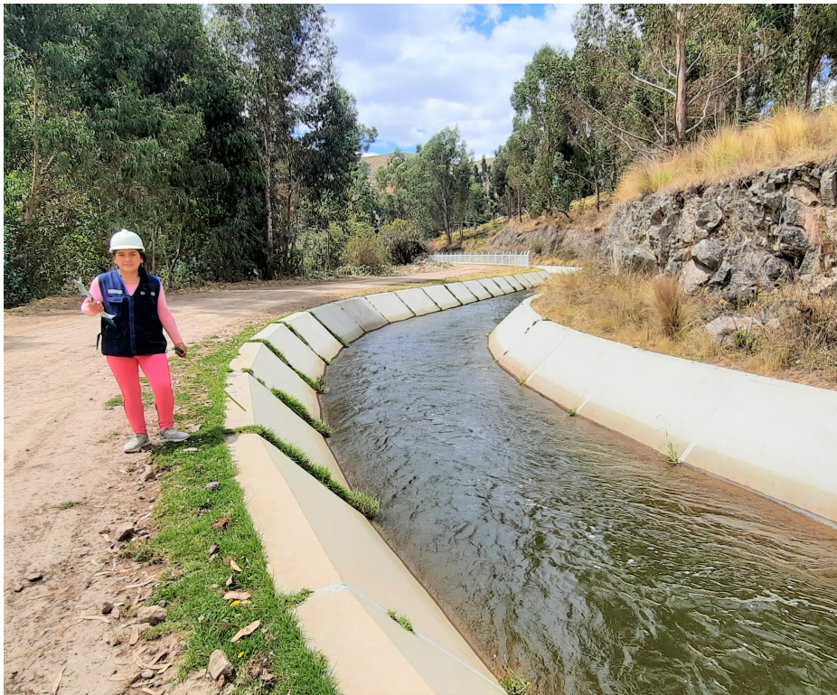
Figura 12 Daño por vegetación
