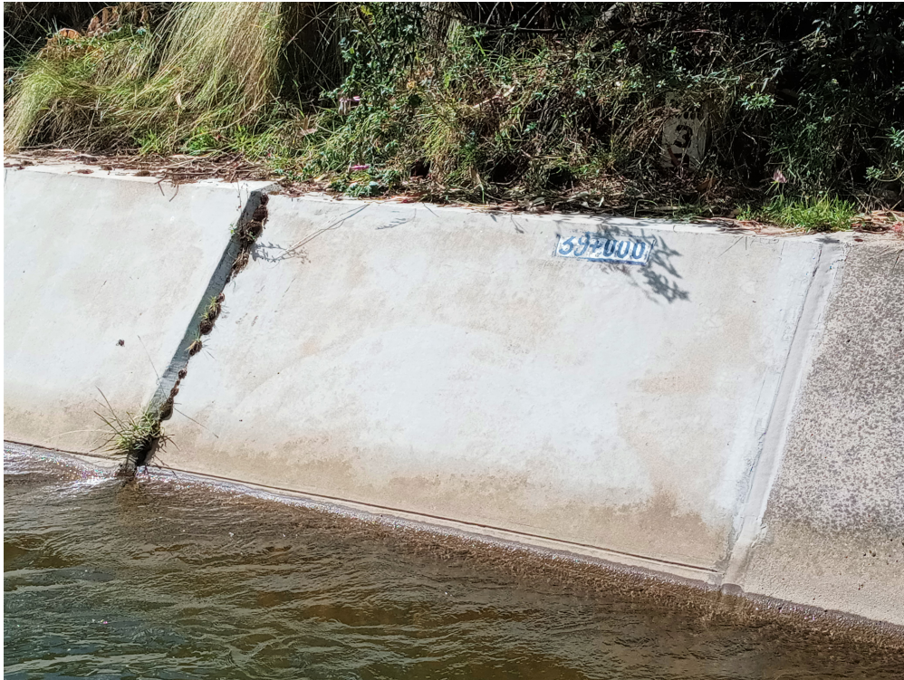
Figura 14 Desplazamiento de juntas en el cuerpo de la estructura
