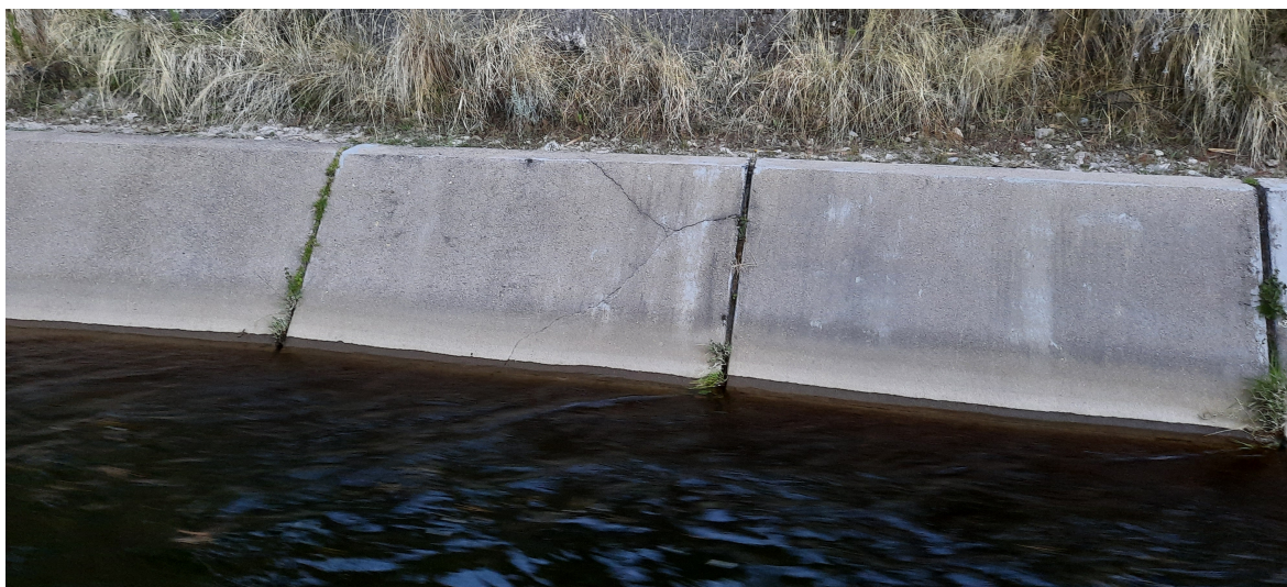
Figura 13 Pérdida total del sello de juntas
