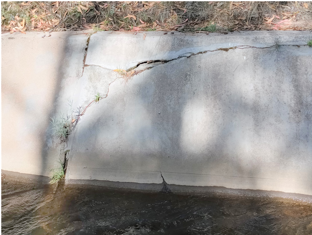
Figura 11 Rotura en el cuerpo de la estructura del canal
