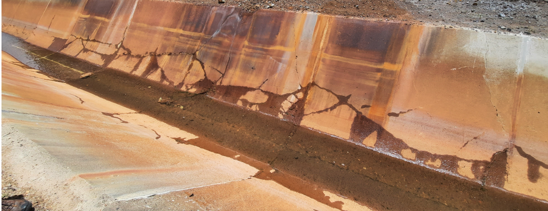
Figura 9 Presencia de grietas en el canal
