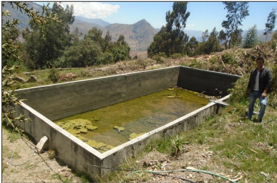
Figura 3.35. Reservorio para almacenamiento de agua – Masinga Tambo
